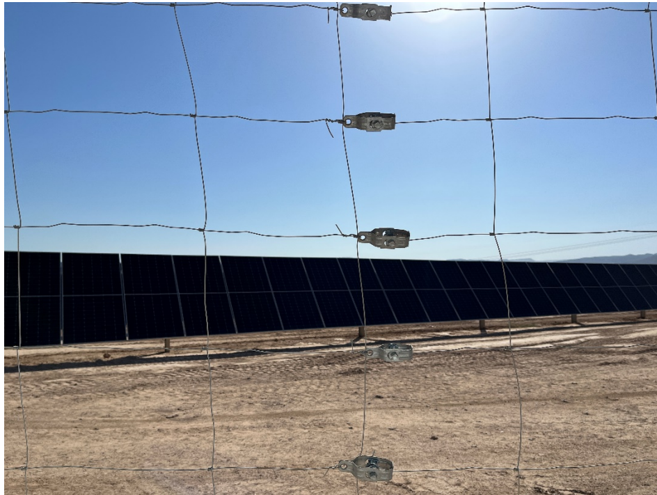
Figura 4 Elementos punzantes en el vallado perimetral
