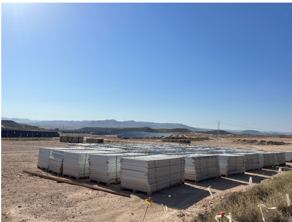
Figura 3 Acopio temporal de residuos no peligrosos
