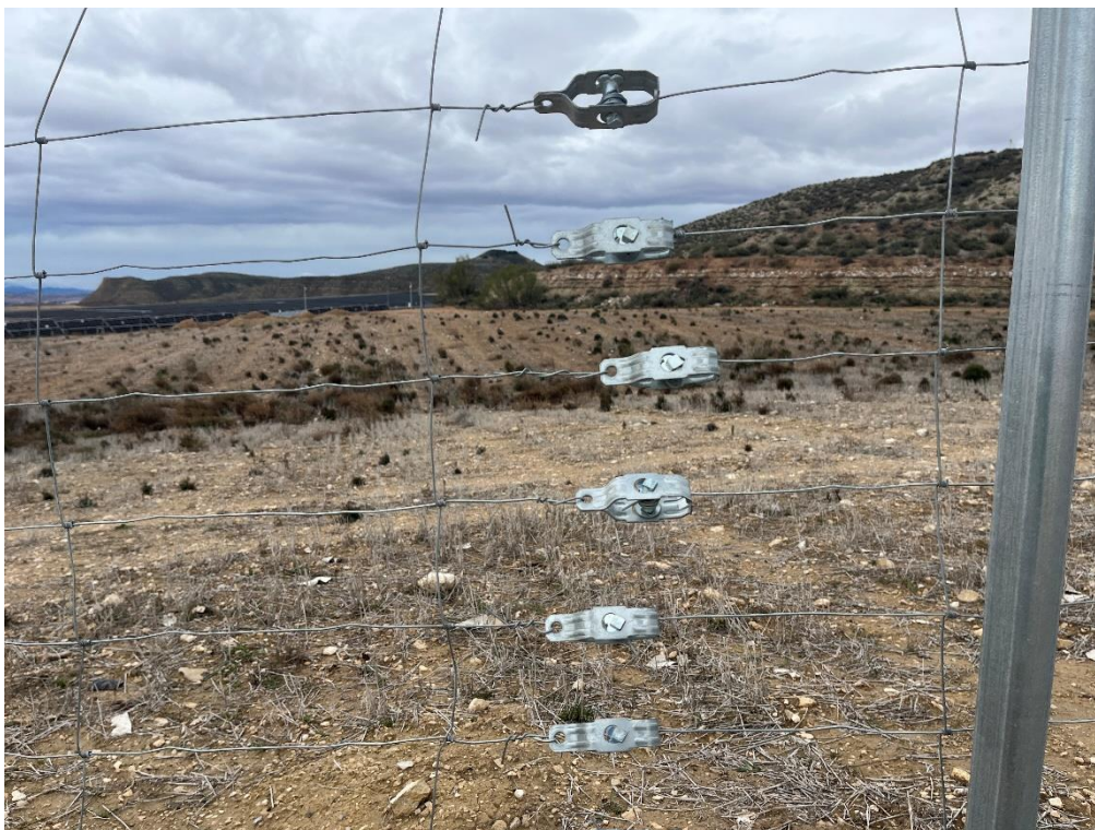
Figura 6 Elementos punzantes en el vallado perimetral
