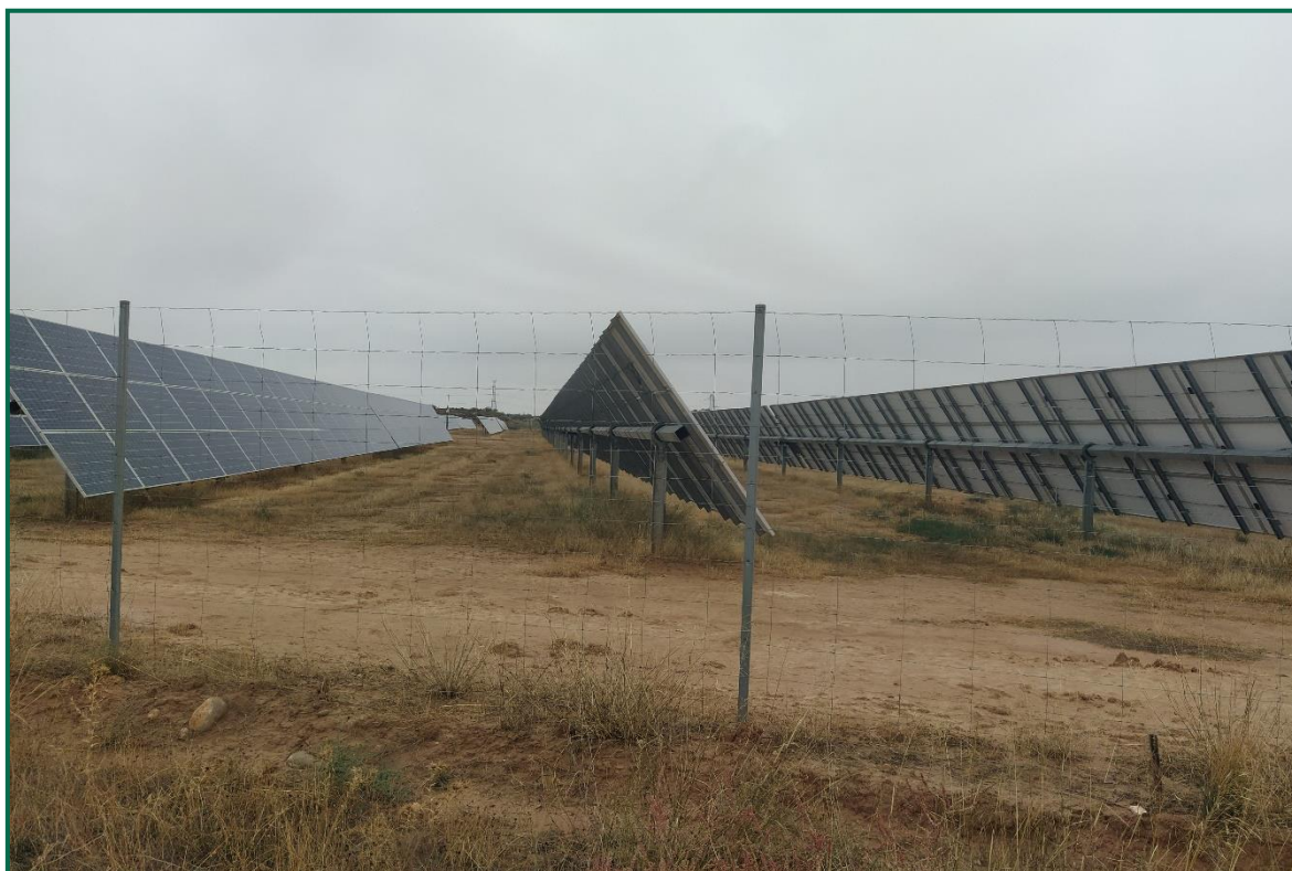
Fotografía 1. Vegetación entre placas actualmente.
