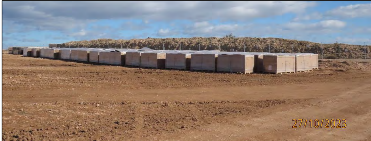
Ilustración 5. Acopio de paneles solares.
