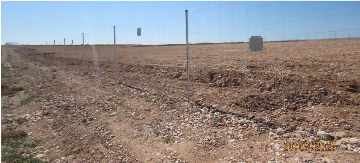
Ilustración 3. Instalación del vallado perimetral y de los elementos que lo visibilizan a la avifauna.
