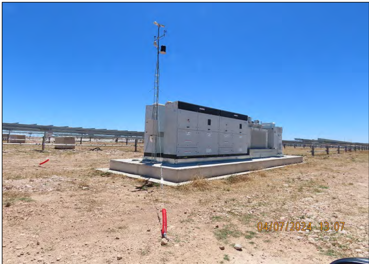
Ilustración 4. Estación meteorológica provisional en Power Station.
