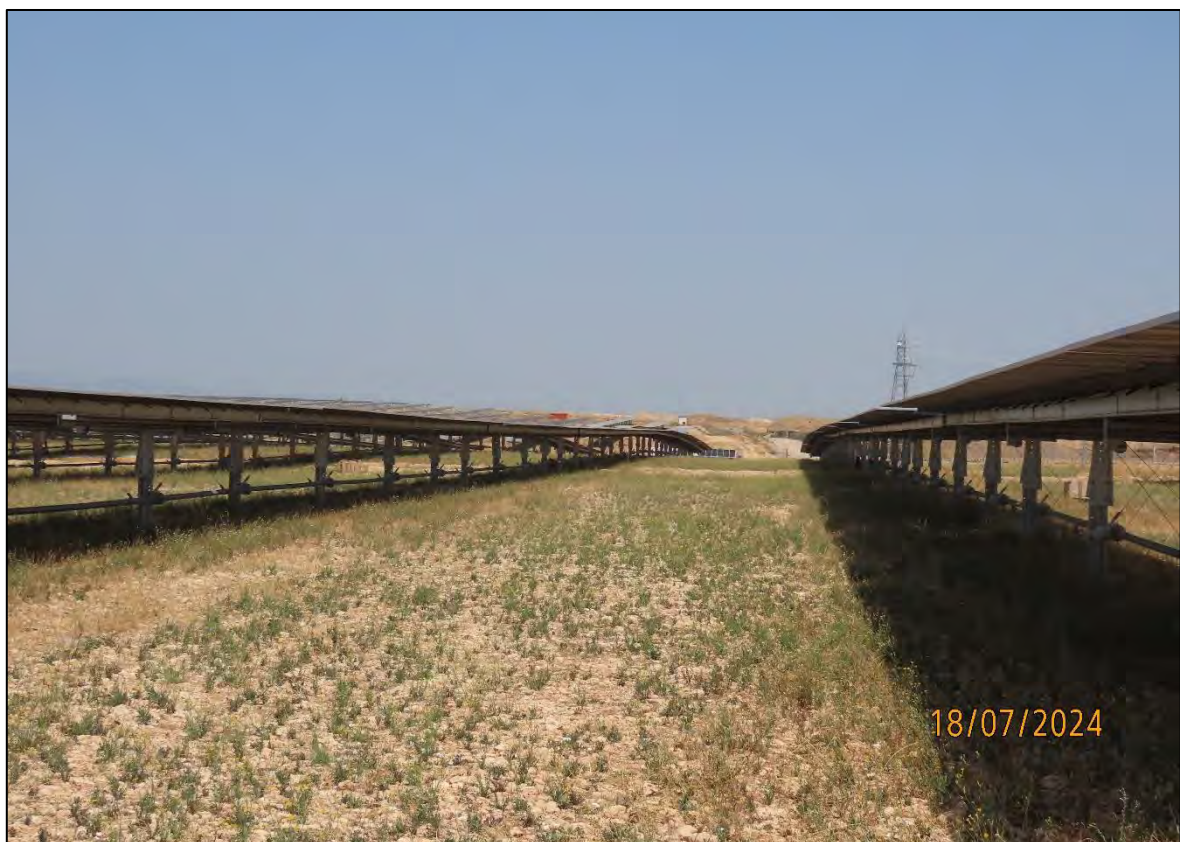
Ilustración 5. Estado actual del parque.
