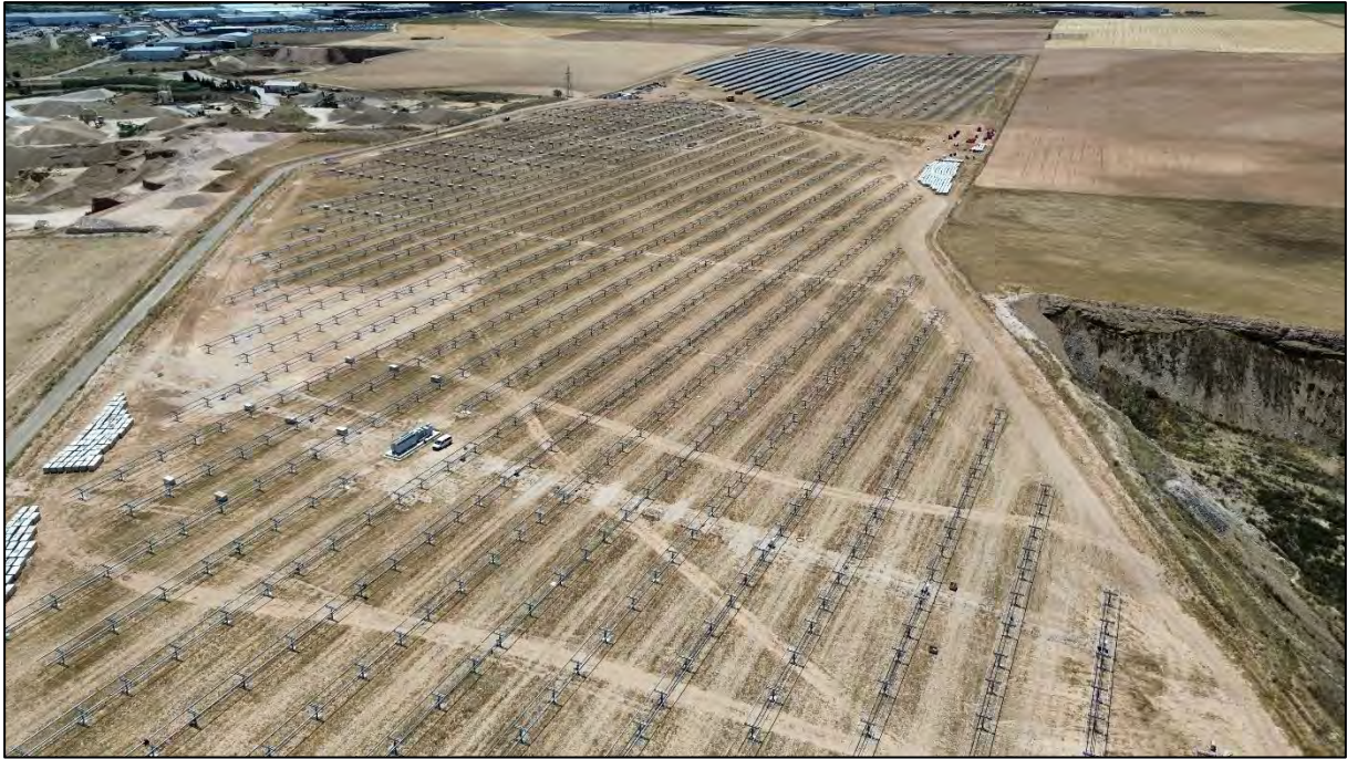
Ilustración 6. Estado actual del parque.
