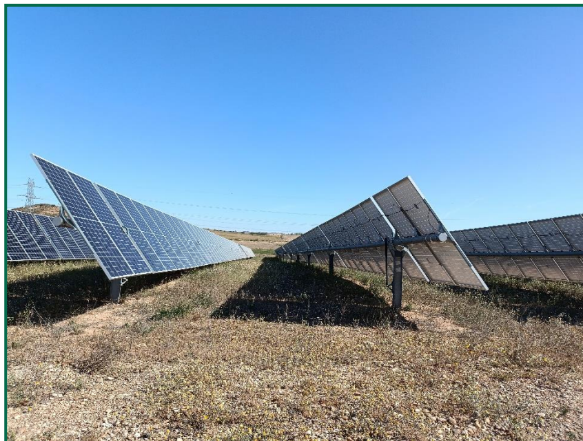
Fotografías 2. Vegetación entre placas actualmente.
