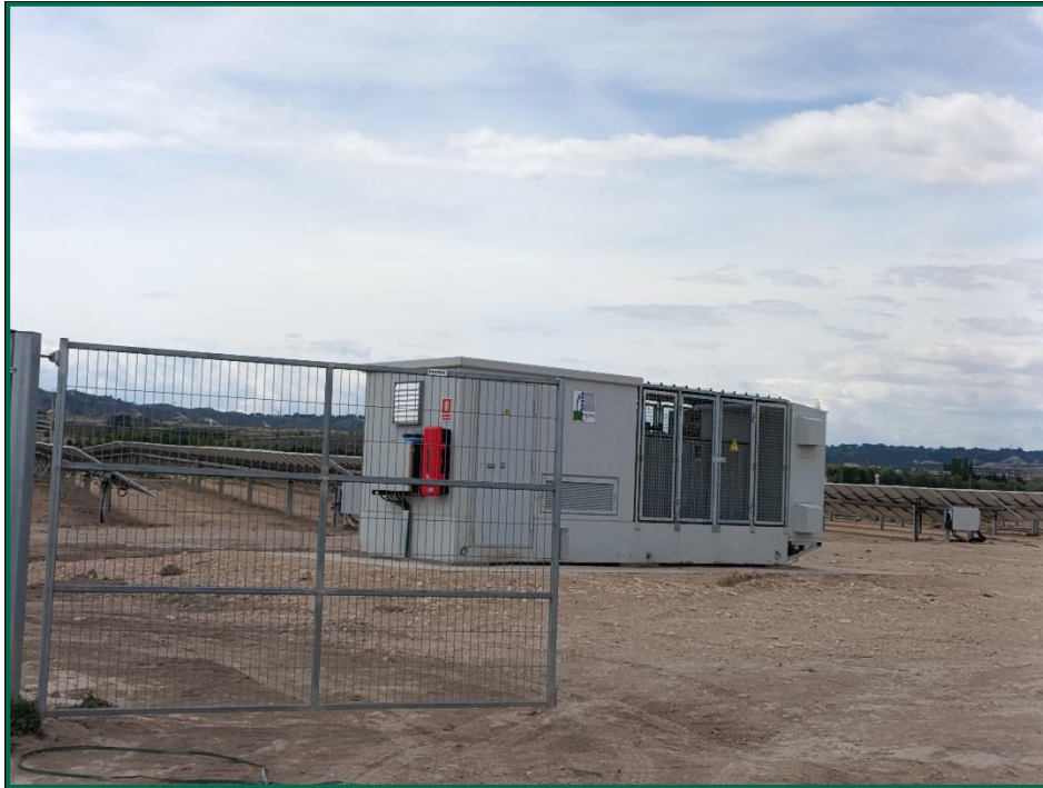
Fotografía 14. Material de extinción.
