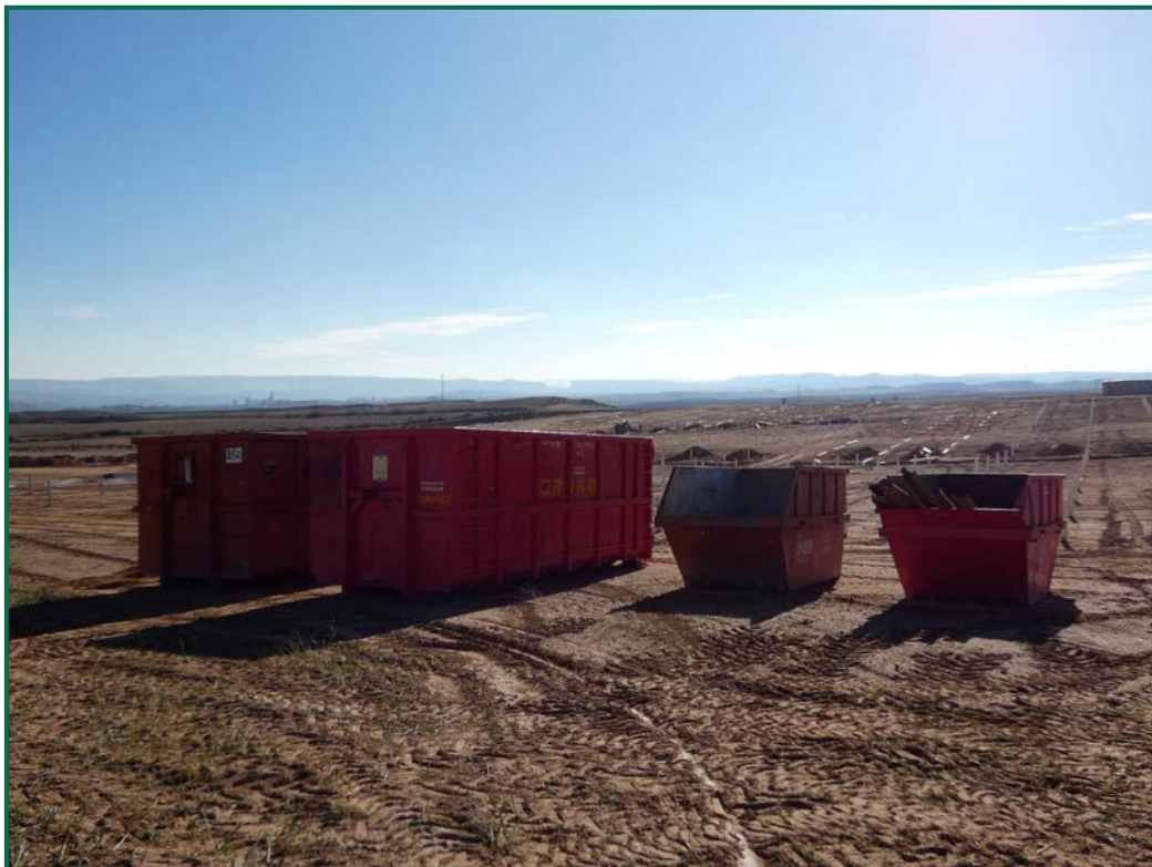
Fotografía 8. Contenedores para inertes.
