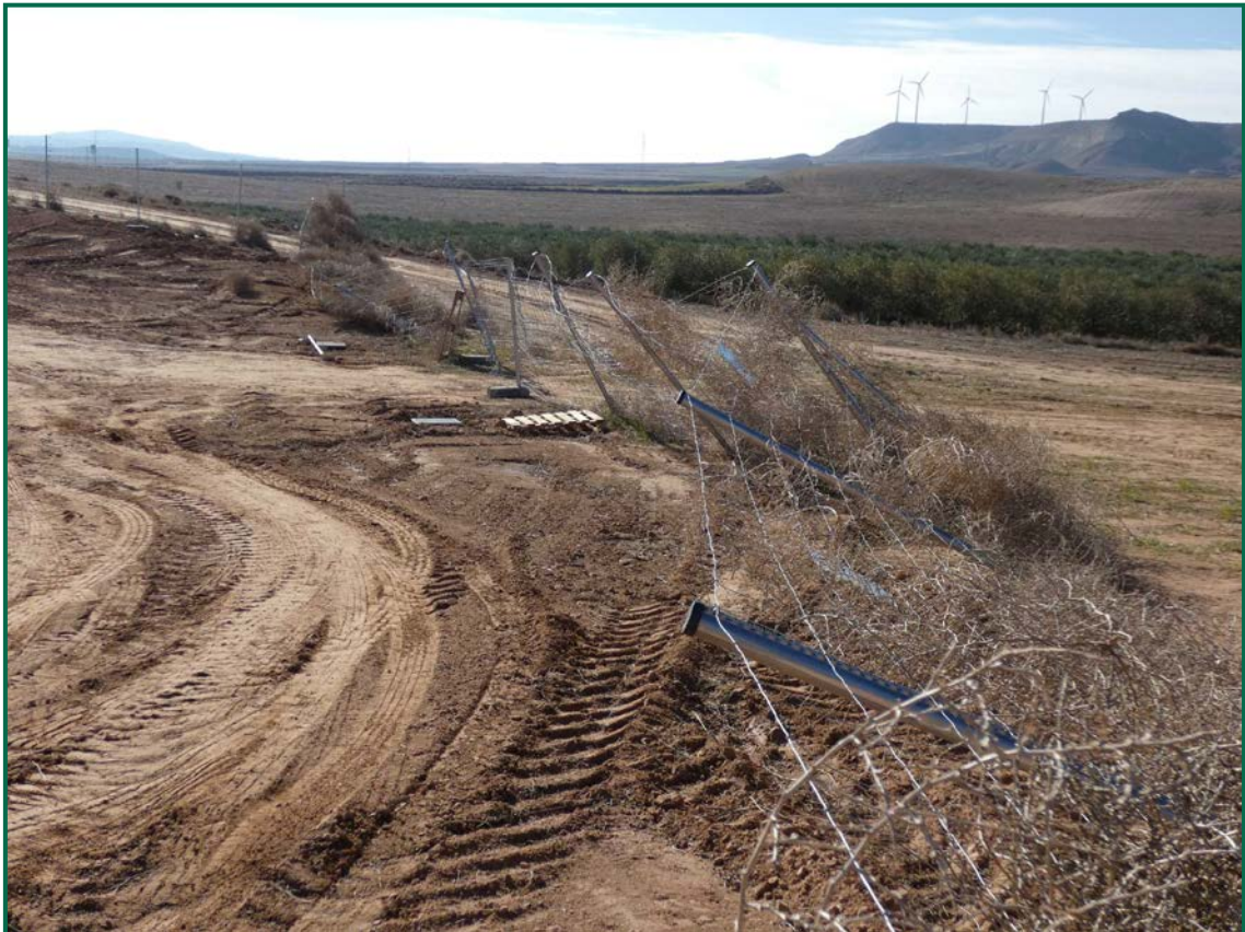
Fotografía 7. Vallado perimetral tumbado por el viento.
