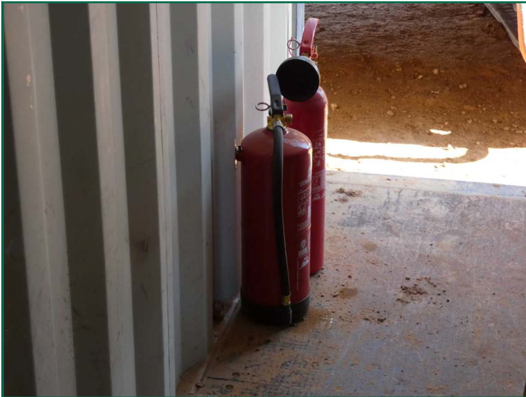
Fotografía 12. Material de extinción.
