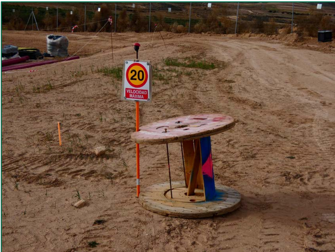
Fotografía 2. Señal de limitación de velocidad.
