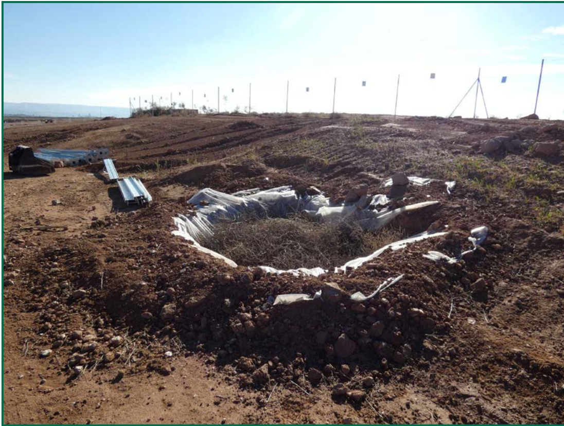
Fotografía 11. Balsa de limpieza.
