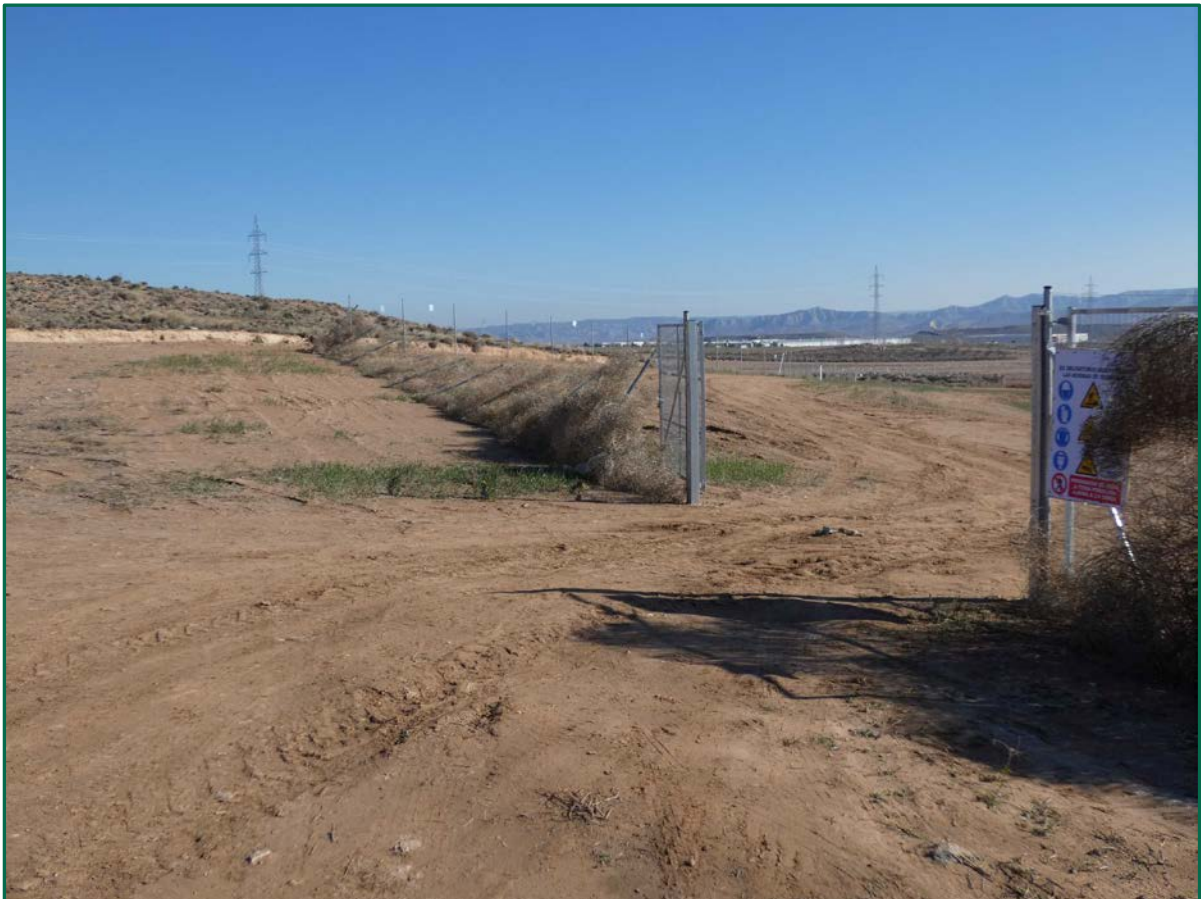
Fotografía 1. Vallado perimetral tumbado por el viento.
