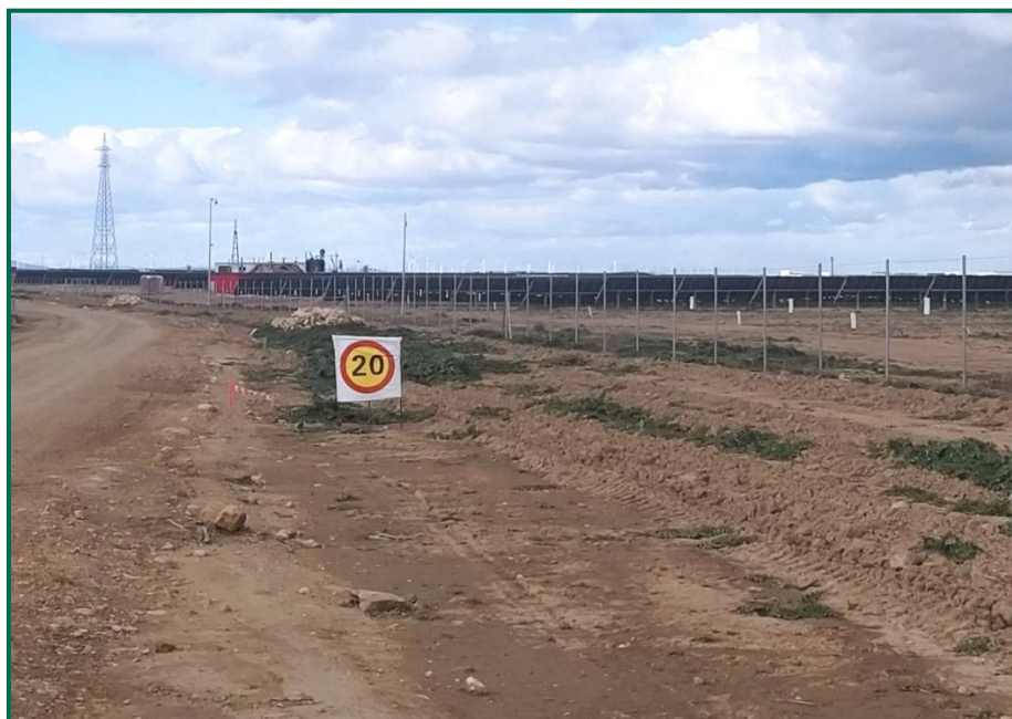
Fotografía 3. Señal de limitación de velocidad.
