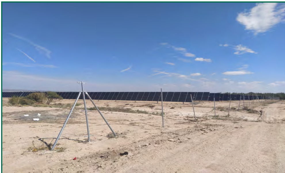
Fotografía 3. Vallado afectado en proceso de reparación.
