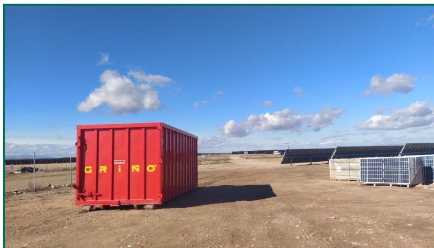
Fotografía 8. Contenedor para voluminosos.
