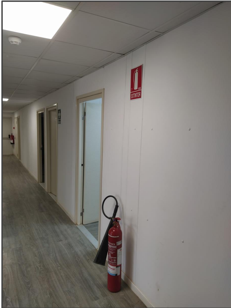
Fotografía 18. Extintores en edificio de control.
