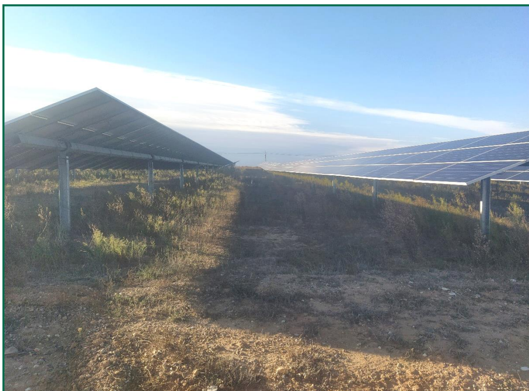
Fotografía 1. Vegetación entre placas en su estado actual.
