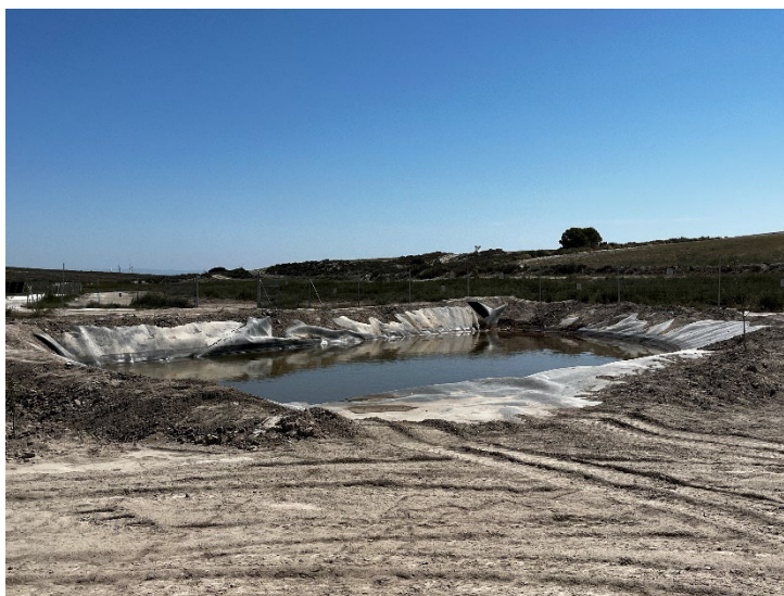
Figura 8 Balsete con acumulación de agua
