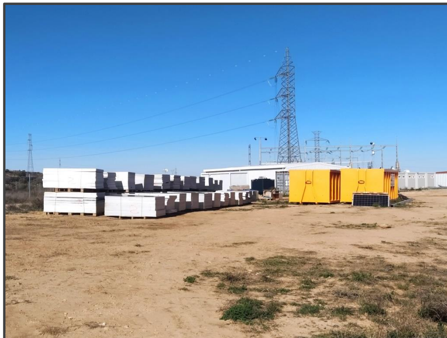
Fotografía 15. Zona de acopio de placas solares deterioradas.
