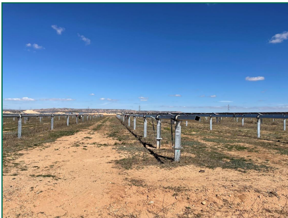
Fotografía 1. Vegetación entre placas actualmente.
