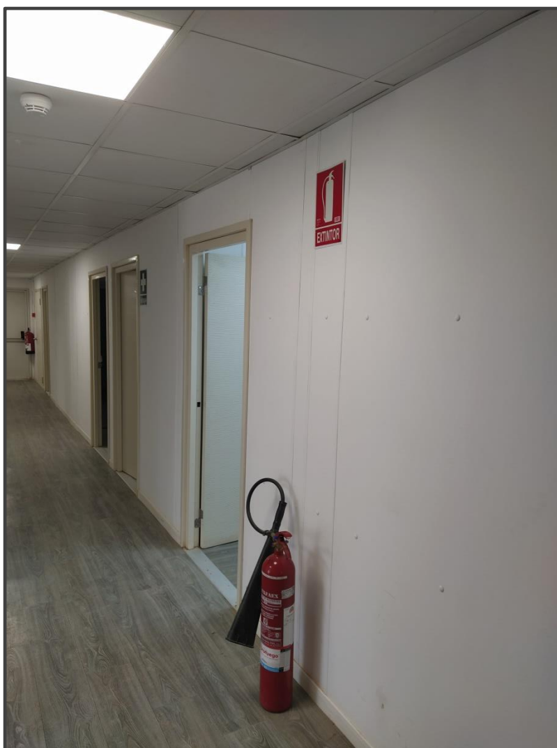
Fotografía 16. Extintores en edificio de control.
