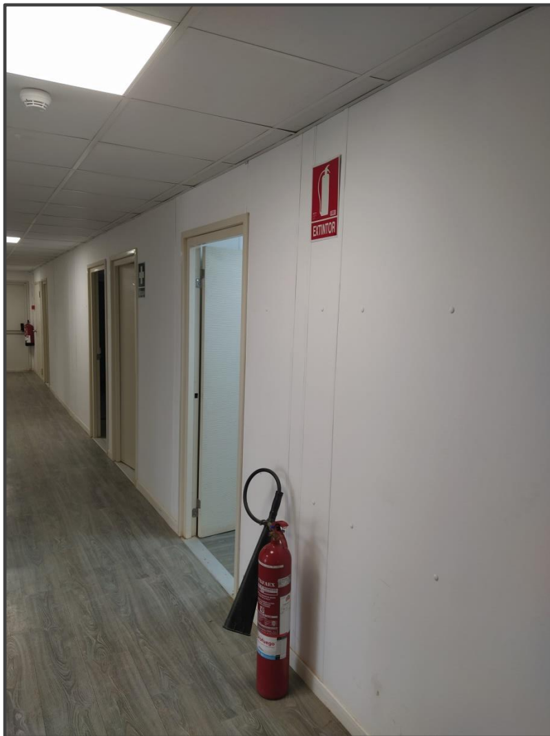
Fotografía 16. Extintores en edificio de control.
