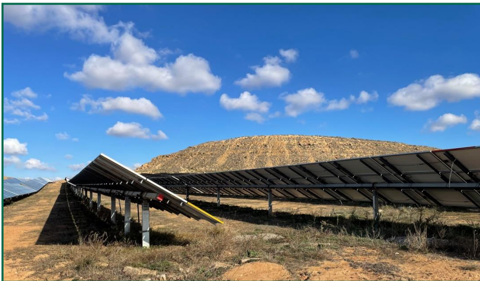
Fotografía 1. Vegetación entre placas actualmente.
