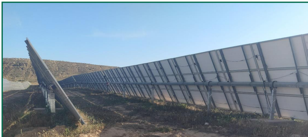
Fotografía 1. Vegetación entre placas actualmente.
