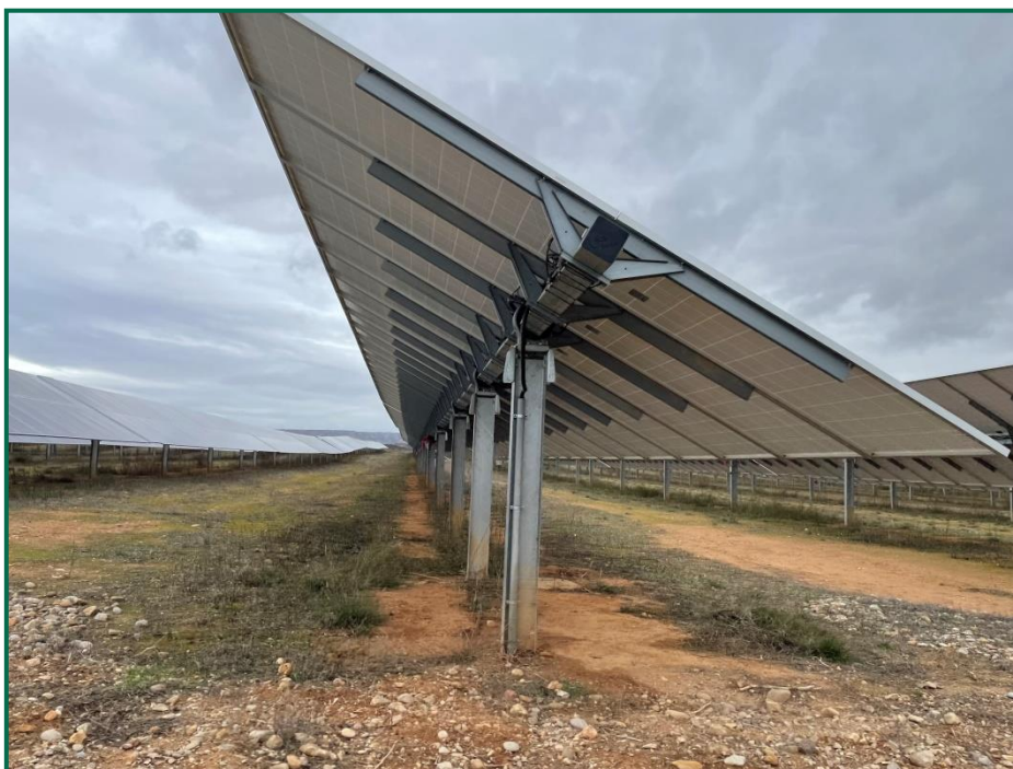
Fotografía 1. Vegetación entre placas actualmente.
