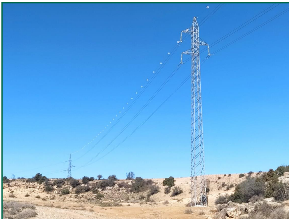
Fotografía 2. Línea eléctrica con balizas salvapájaros
