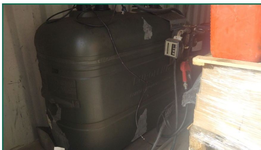
Fotografía 15. Bidón de gasoil sobre bandeja.
