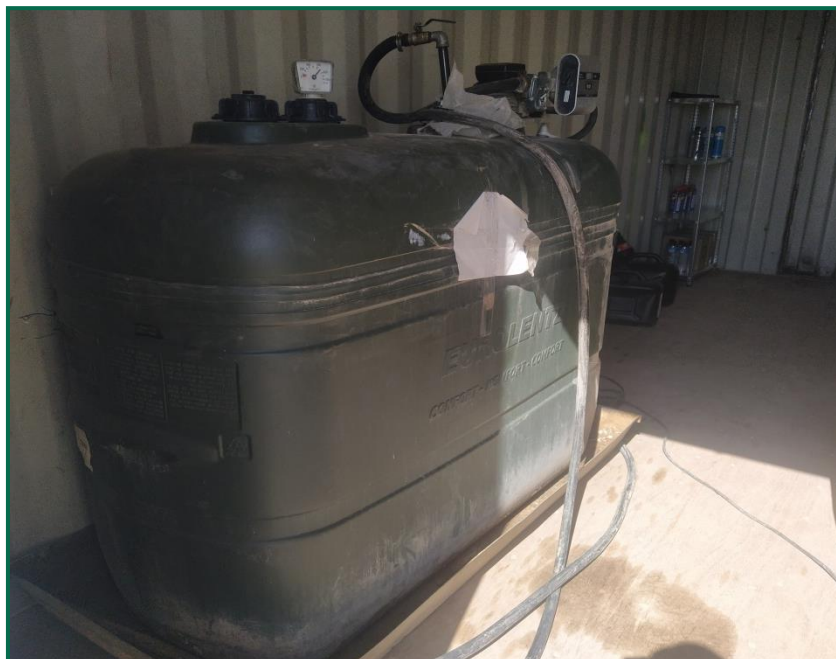
Fotografía 10. Bidón de gasoil sobre bandeja.
