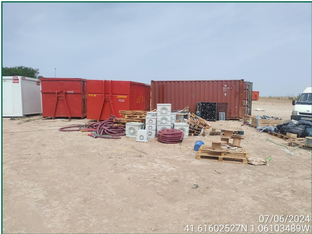
Fotografía 17. Contenedores de residuos y restos de materiales.
