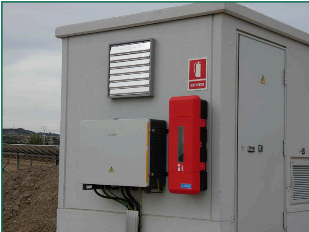
Fotografía 31. Extintor en la caseta del inversor.
