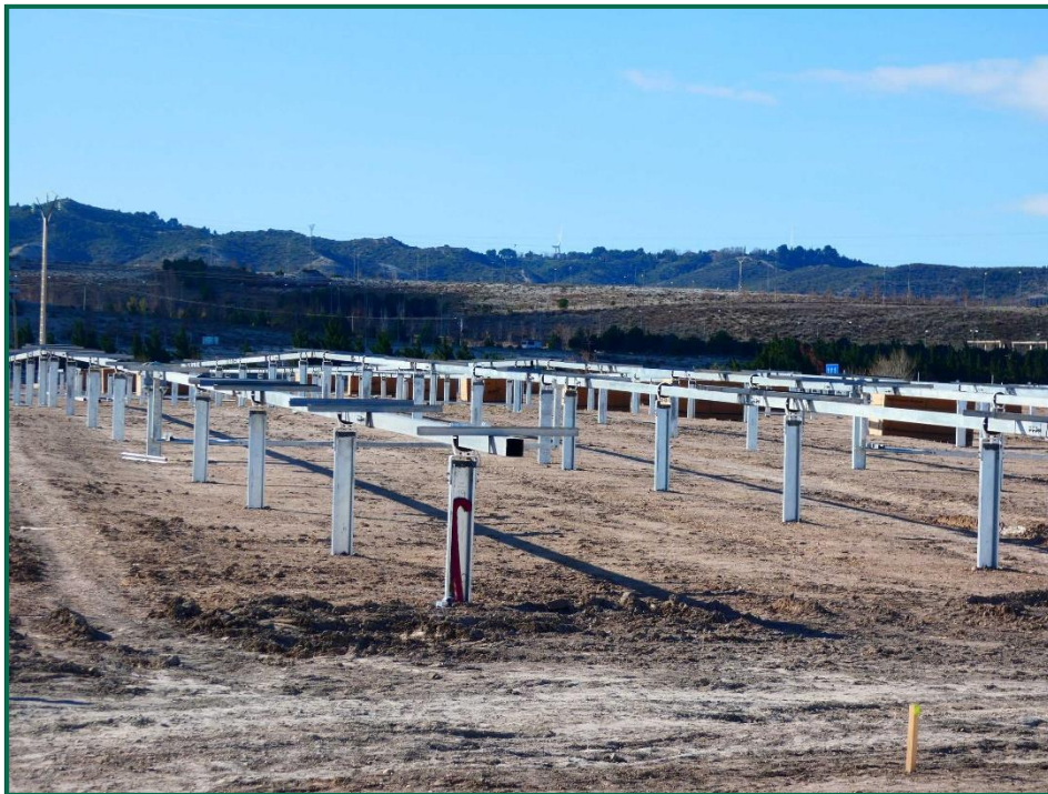
Fotografía 6. Postes verticales y horizontales para las placas fotovoltaicas.
