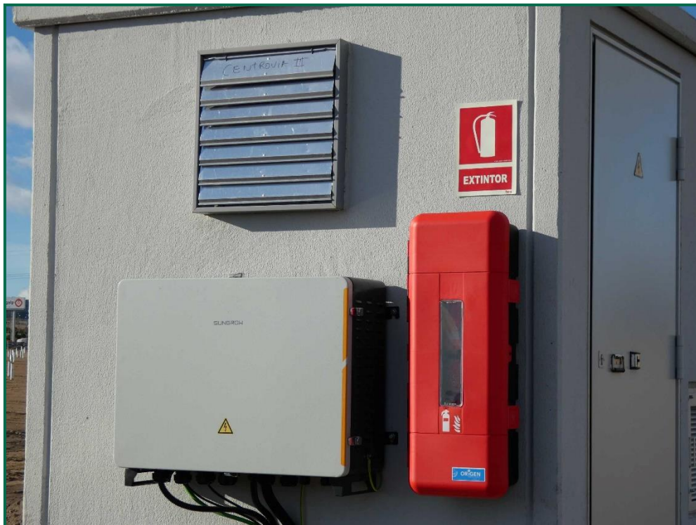
Fotografía 19. Extintor en la caseta del inversor.
