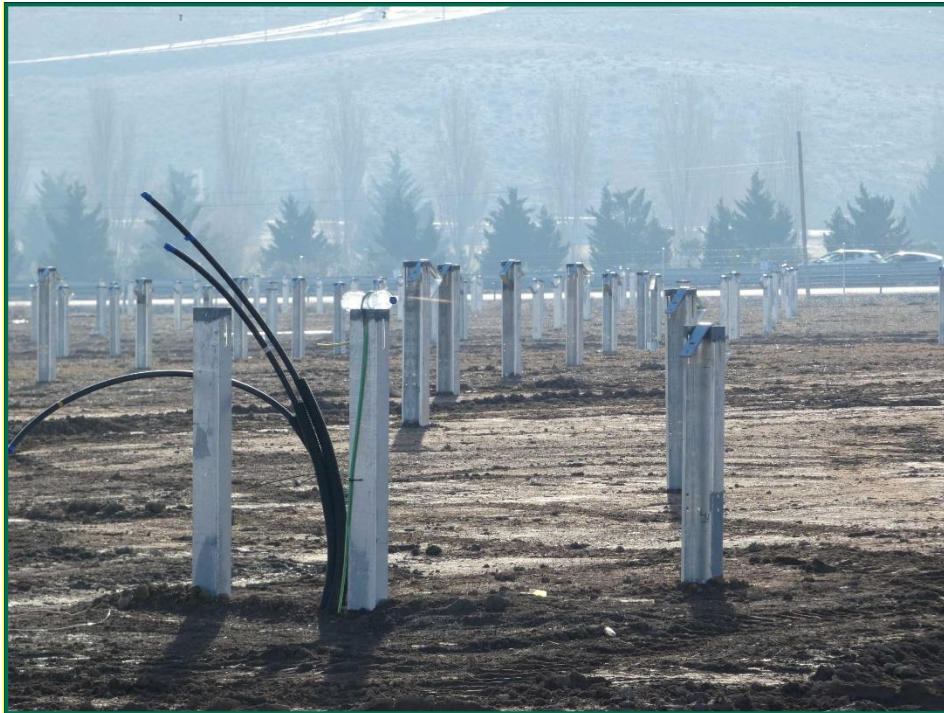
Fotografía 4. Postes de los inverores y para las placas fotovoltaicas.
