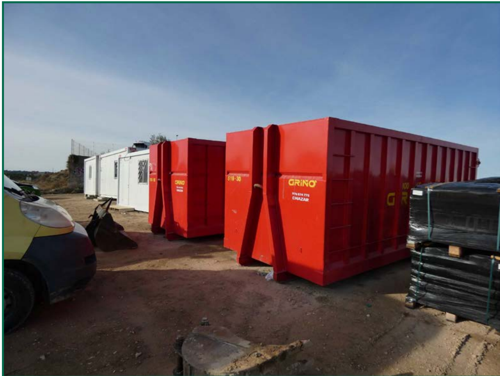
Fotografía 9. Contenedores de residuos.
