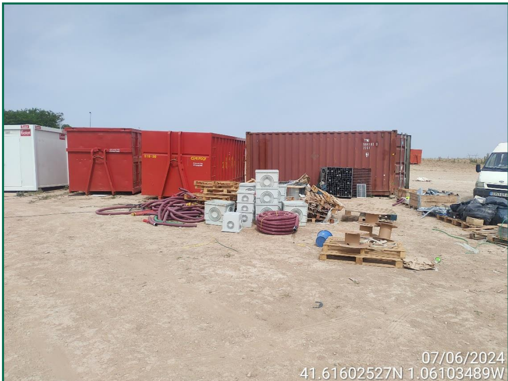
Fotografía 16. Contenedores de residuos y restos de materiales.
