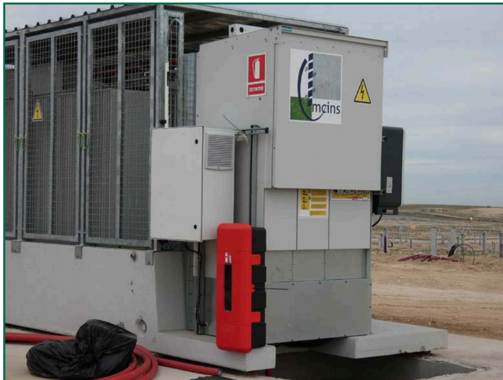
Fotografía 28. Caseta del inversor y equipo de extinción.
