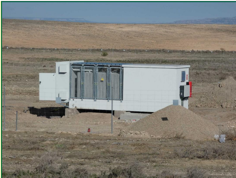
Fotografía 5. Inversor y acopios de tierra.
