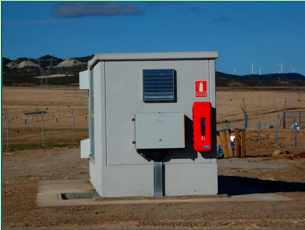
Fotografía 24. Caseta del inversor y equipo de extinción.
