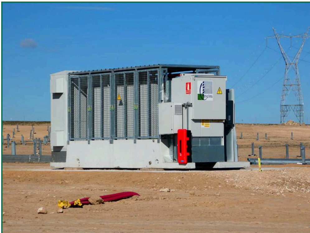
Fotografía 28. Extintor en la caseta del inversor.
