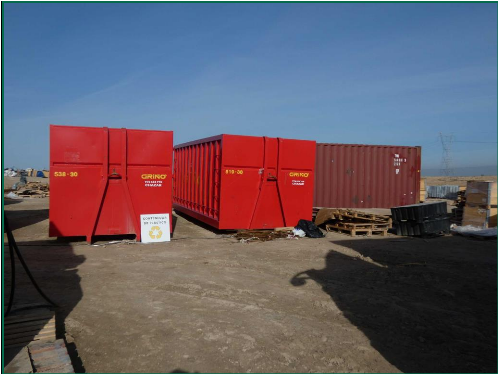
Fotografía 22. Contenedores de residuos.
