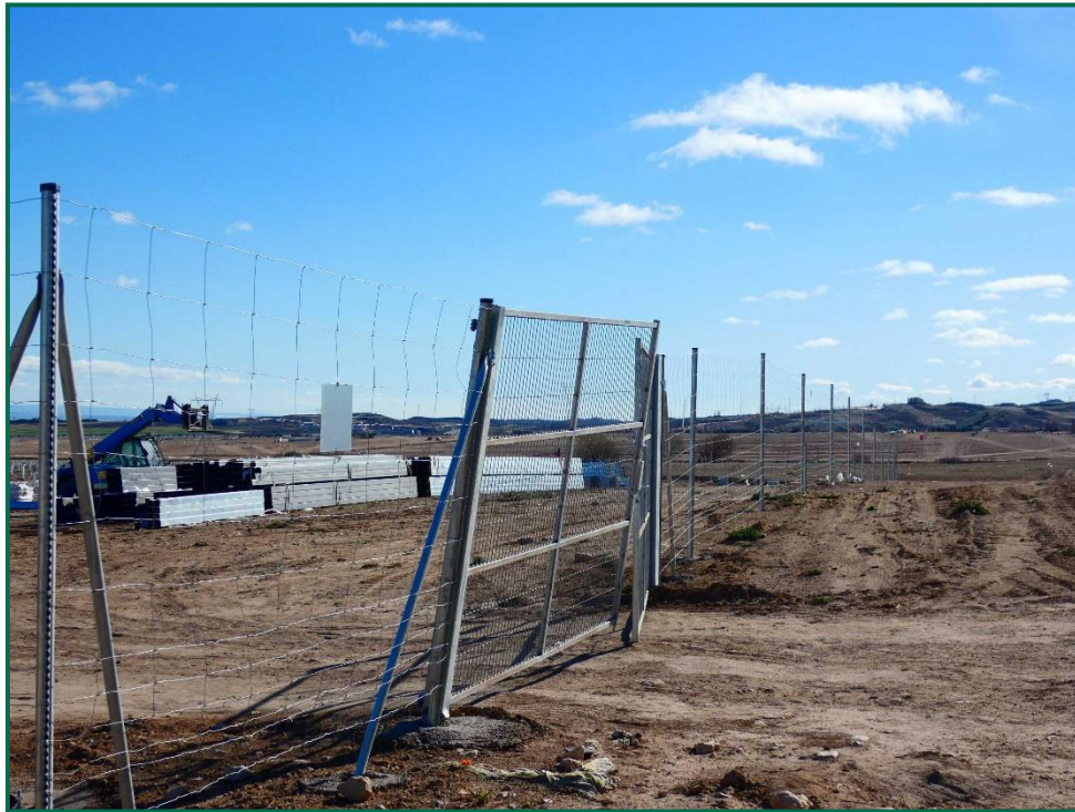
Fotografía 12. Puerta de acceso doblada por la acción del viento.
