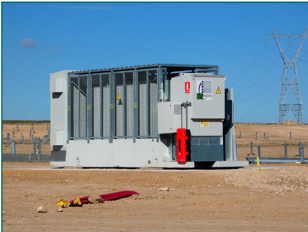
Fotografía 27. Extintor en la caseta del inversor.
