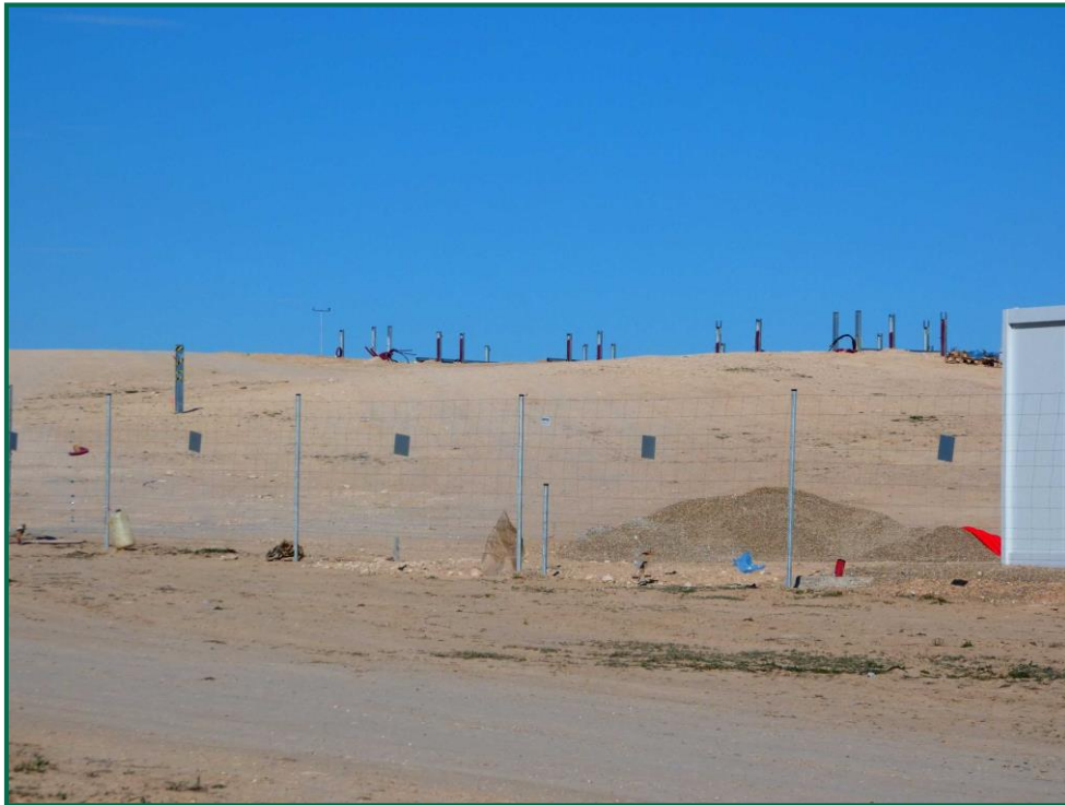
Fotografía 14. Placas anticolidión y vallado perimetral.
