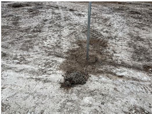
Figura 23 Pequeños vertidos de hormigón
