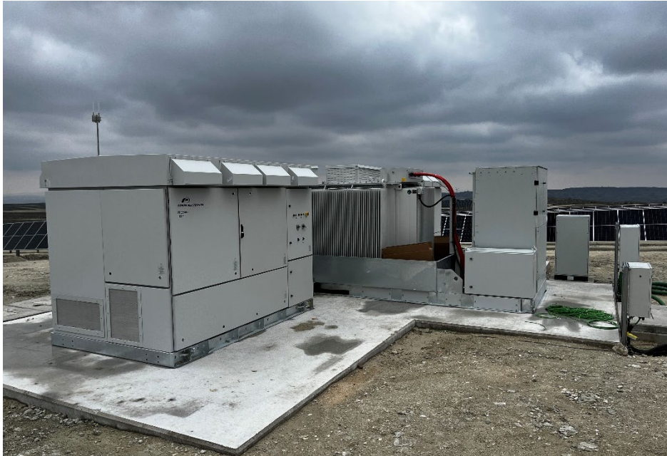
Figura 43 Centro de transformación
