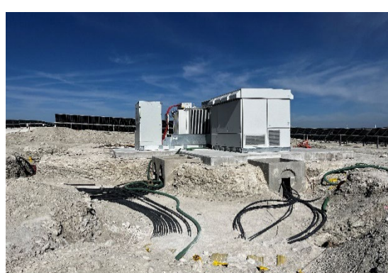
Figura 12 Cableado de los centros de transformación
