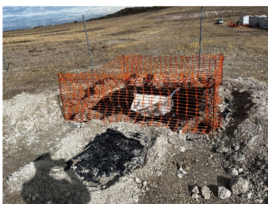
Figura 23 Lavadero de cubas de hormigón
