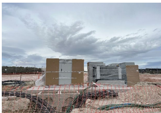
Figura 12 Cableado de los centros de transformación
