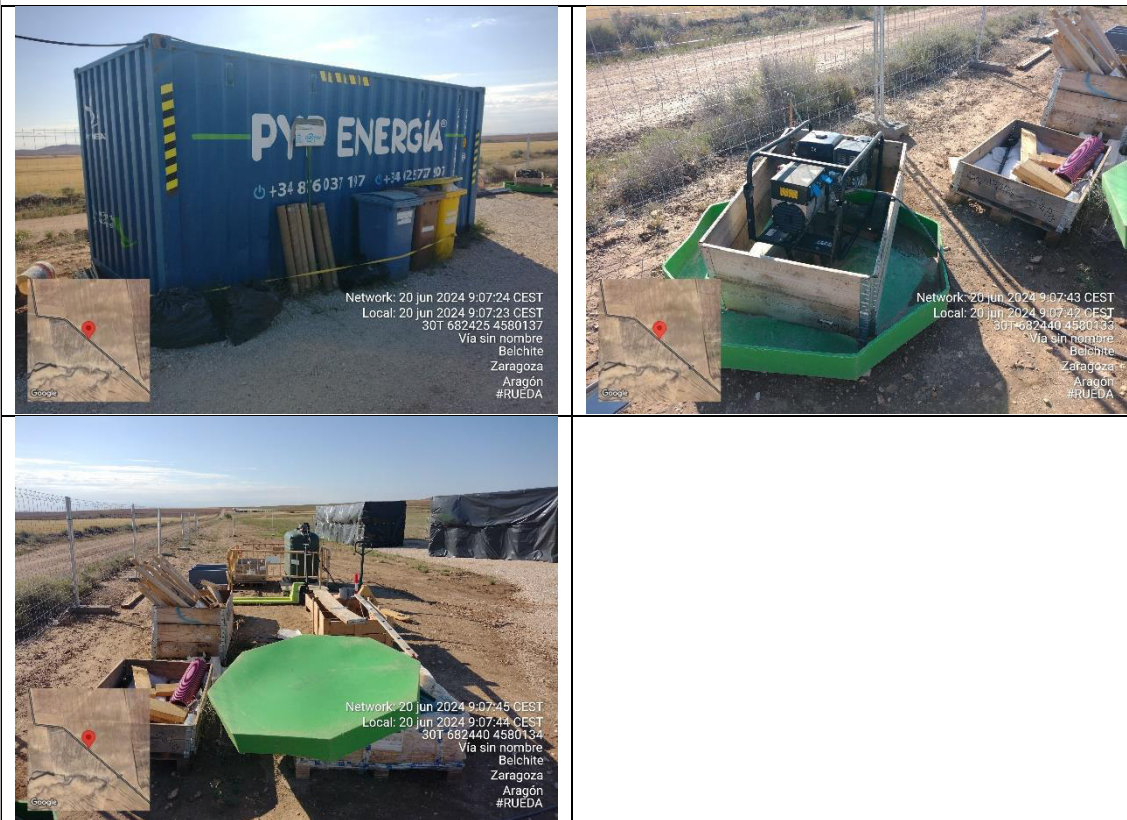
Punto limpio. Zona de repostaje. Cartelería deteriorada.
