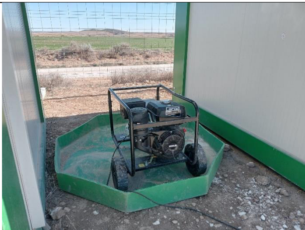
Generador electrico dentro de plataforma para evitar contaminación por vertidos
