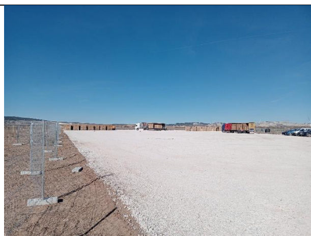
Zona de acopio 1, desde un ángulo que se puede ver la disposición de los pallets de paneles solares, con el vallado de obra.
