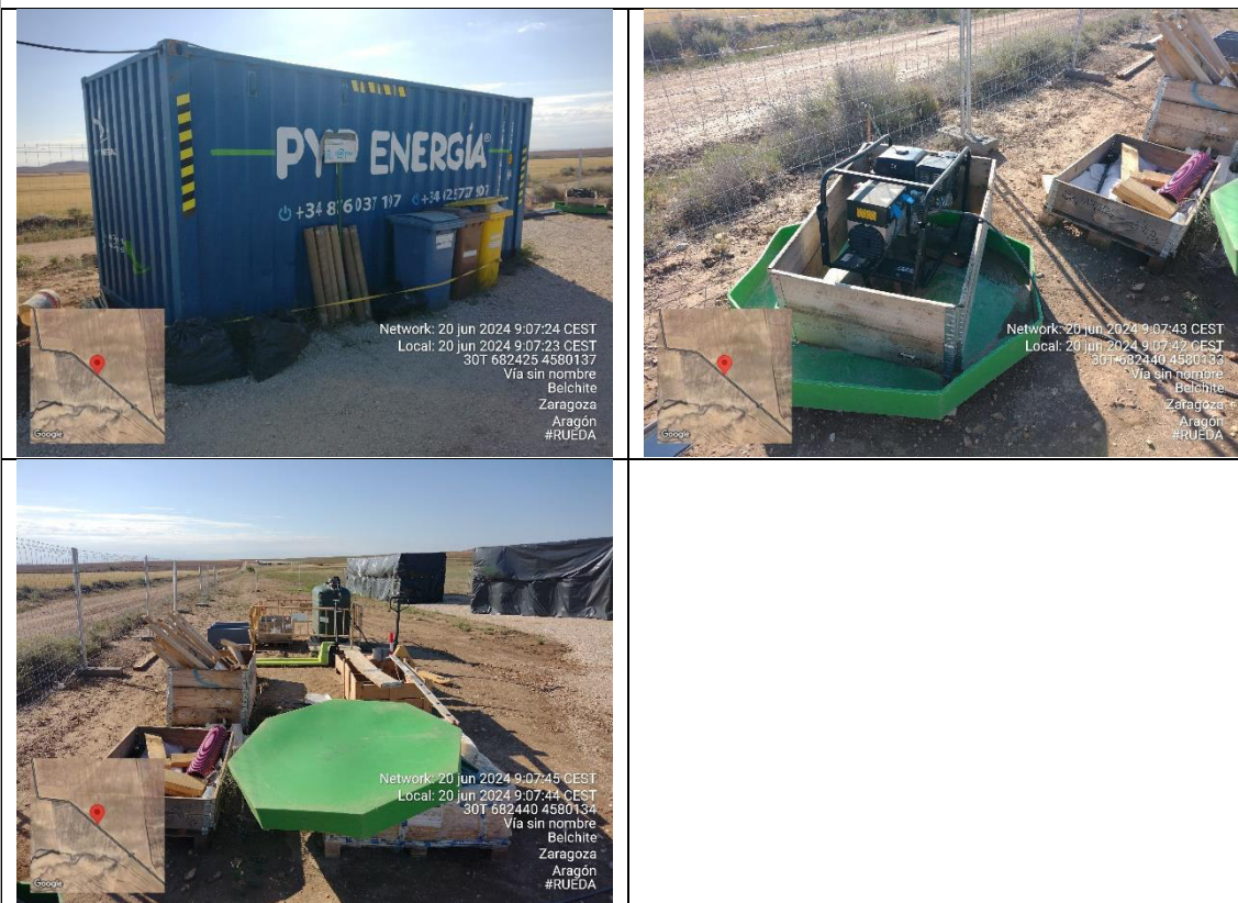
Punto limpio. Zona de repostaje. Cartelería deteriorada.
