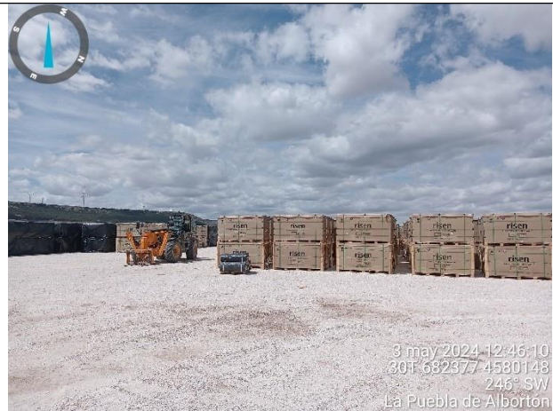
Área de acopio de paneles solares, cubiertos por lona.
