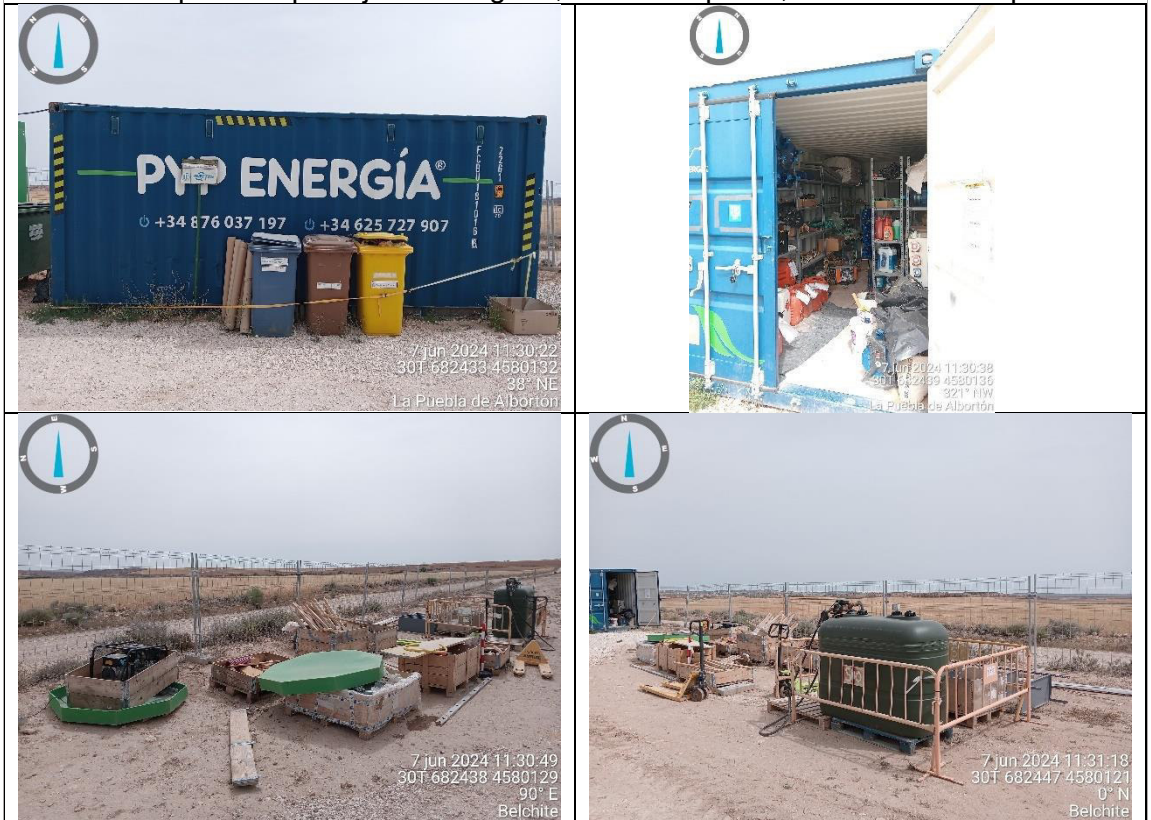
Contenedores y zona de repostaje en punto limpio.
