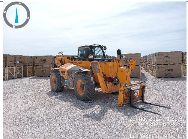
Área de acopio III de paneles solares con la maquinaria para mover los paneles.
