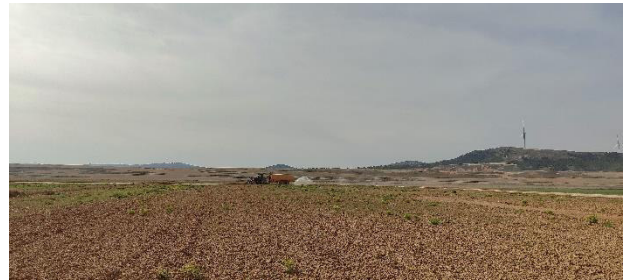
Campa conjunta para futuras infraestructuras auxiliares. Durante el proceso de humectación del terreno para el asentamiento de la zahorra.
