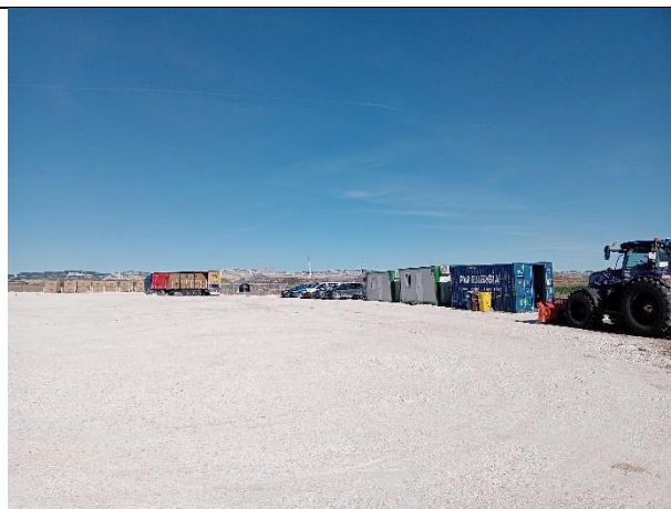
Zona de acopio 1, con las oficinas, zona de aparcamiento de coches de operarios y maquinaria de obra, así como las casetas y zona de punto limpio.
