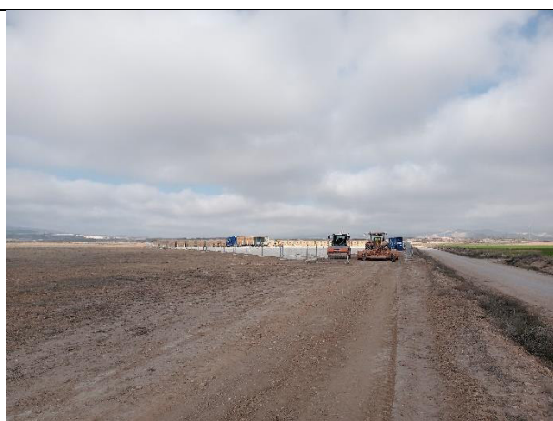
Camino de union de las zonas de acopio 1, 2 y 3. Hacia la zona de acopio 1, con la zona de estacionamiento de maquinaria y casetas auxiliares.
