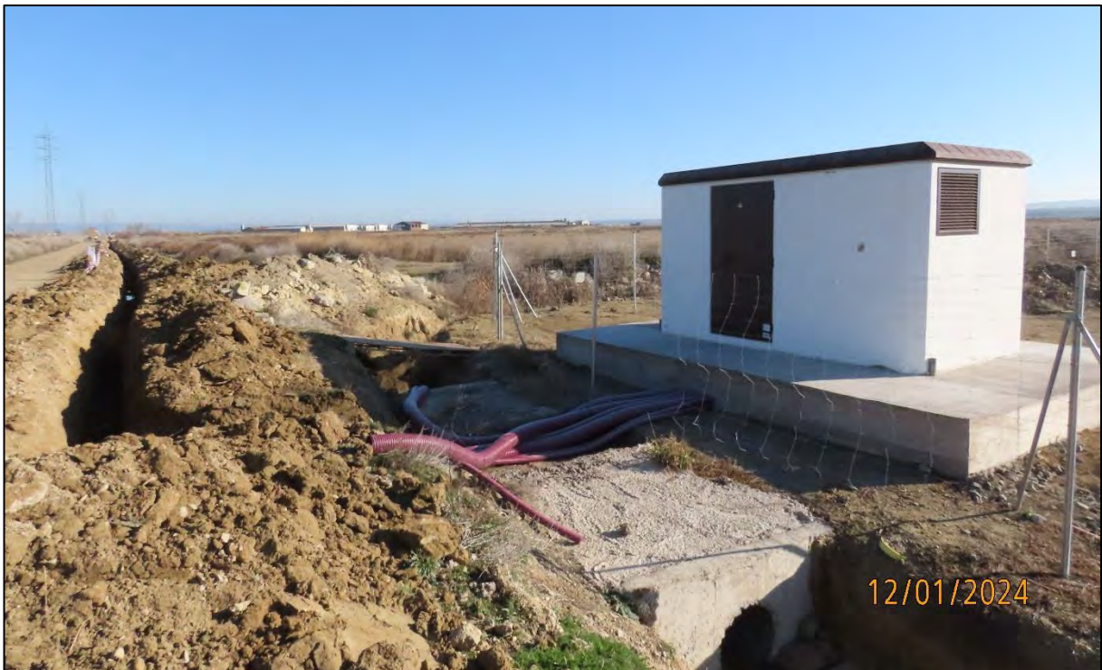
Ilustración 4. Comienzo de la zanja que alojará la LSMT, desde el Centro de Seccionamiento.
