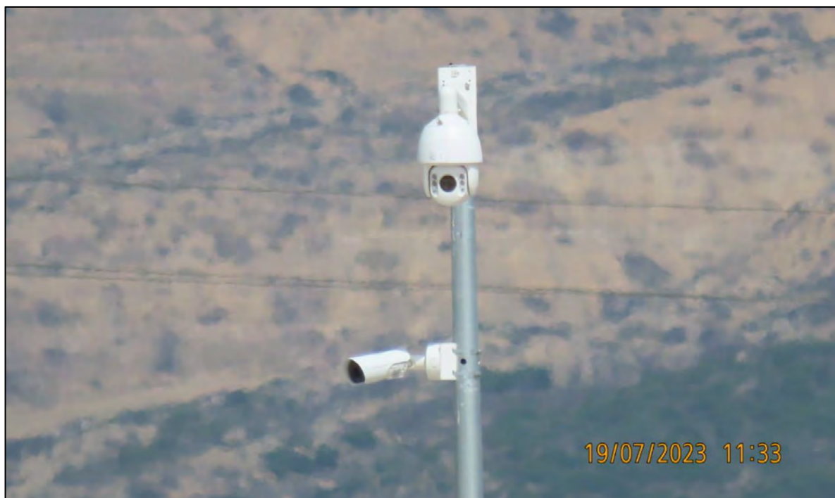
Ilustración 32. Sistema de videovigilancia ejecutado.
