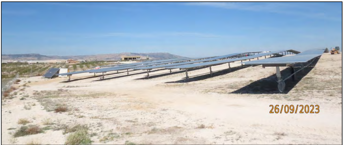
Ilustración 38. Módulos fotovoltaicos colocados.
