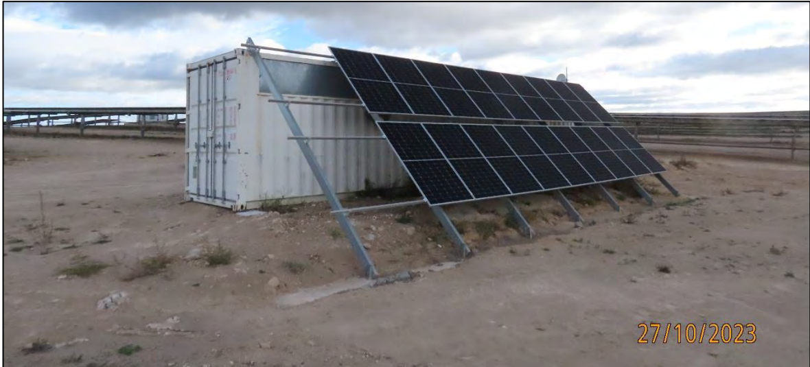
Ilustración 46. Caseta de obra con sistema energético.
