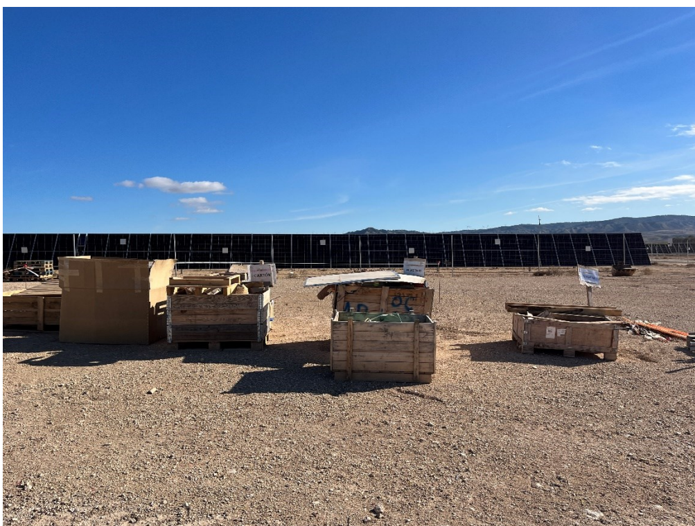
Figura 3 Punto limpio de residuos no peligrosos
