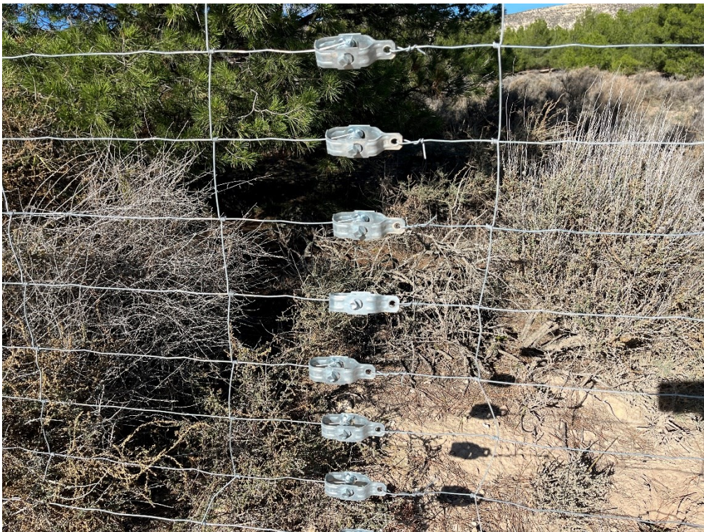
Figura 7 Elementos punzantes en el vallado perimetral
