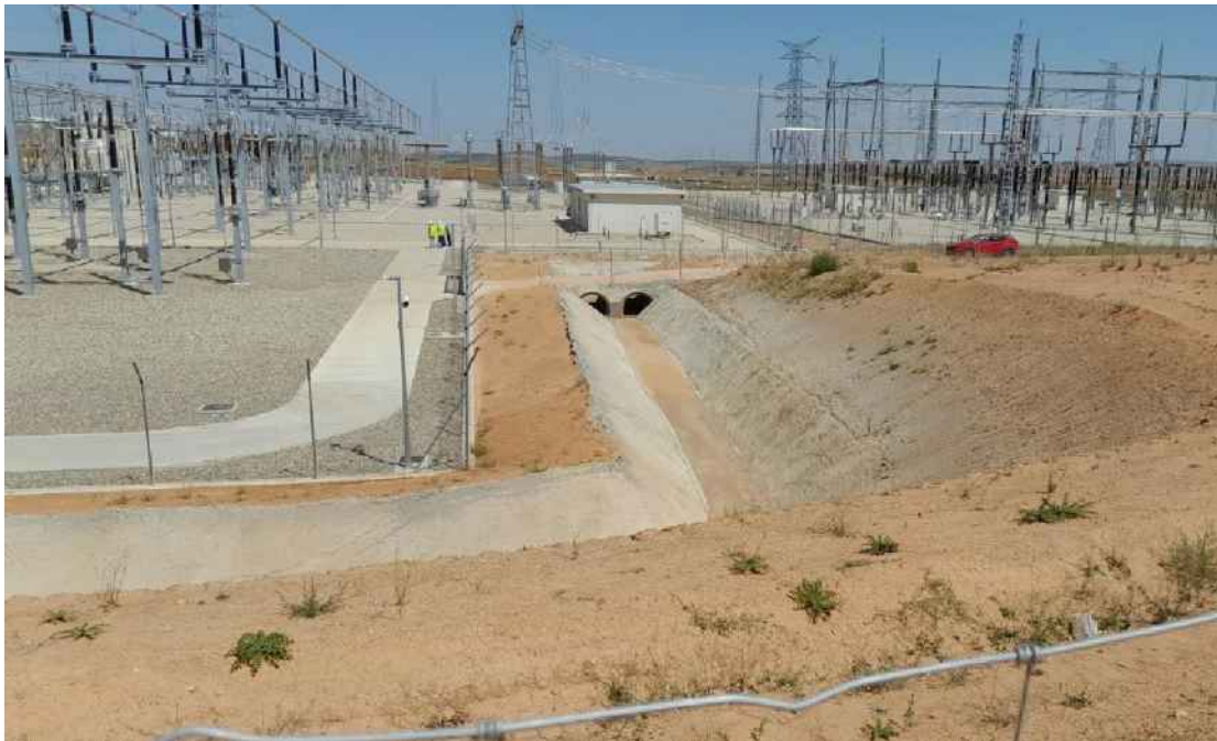
Foto 51. Vista general de la subestación. Enfoque en el sistema de drenaje. Mes de agosto 2023.
