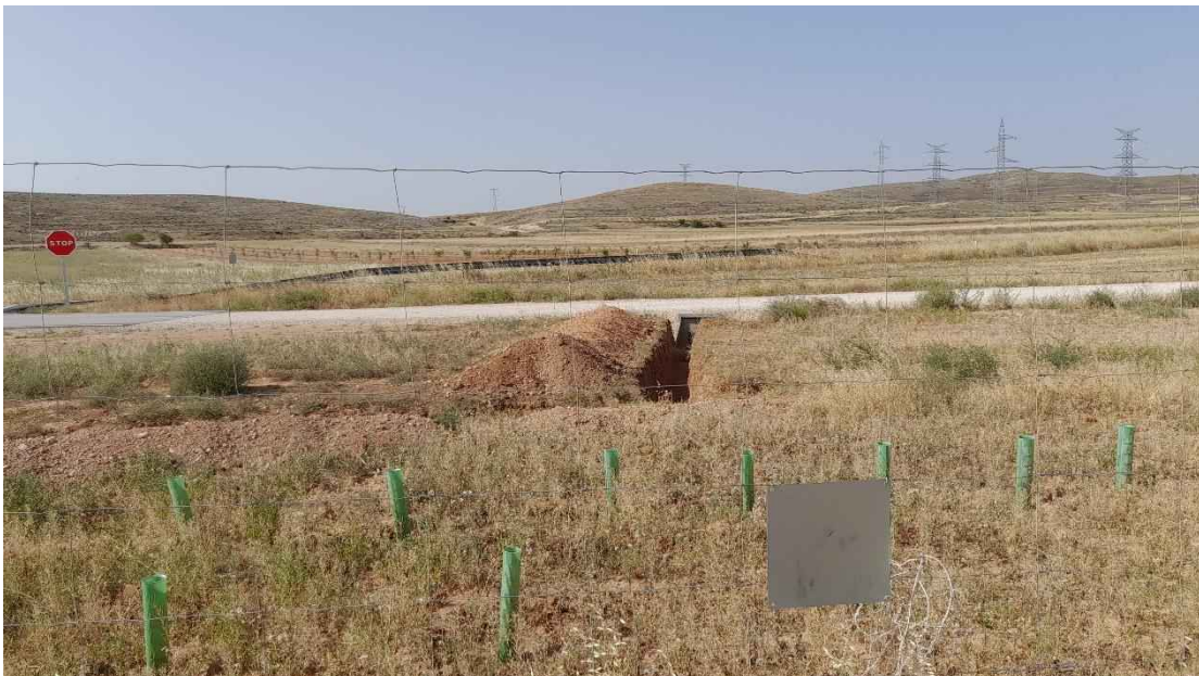
Foto 26. Sistema de drenaje en la zona contigua a la carretera A-2306 en el acceso a la planta fotovoltaica.
