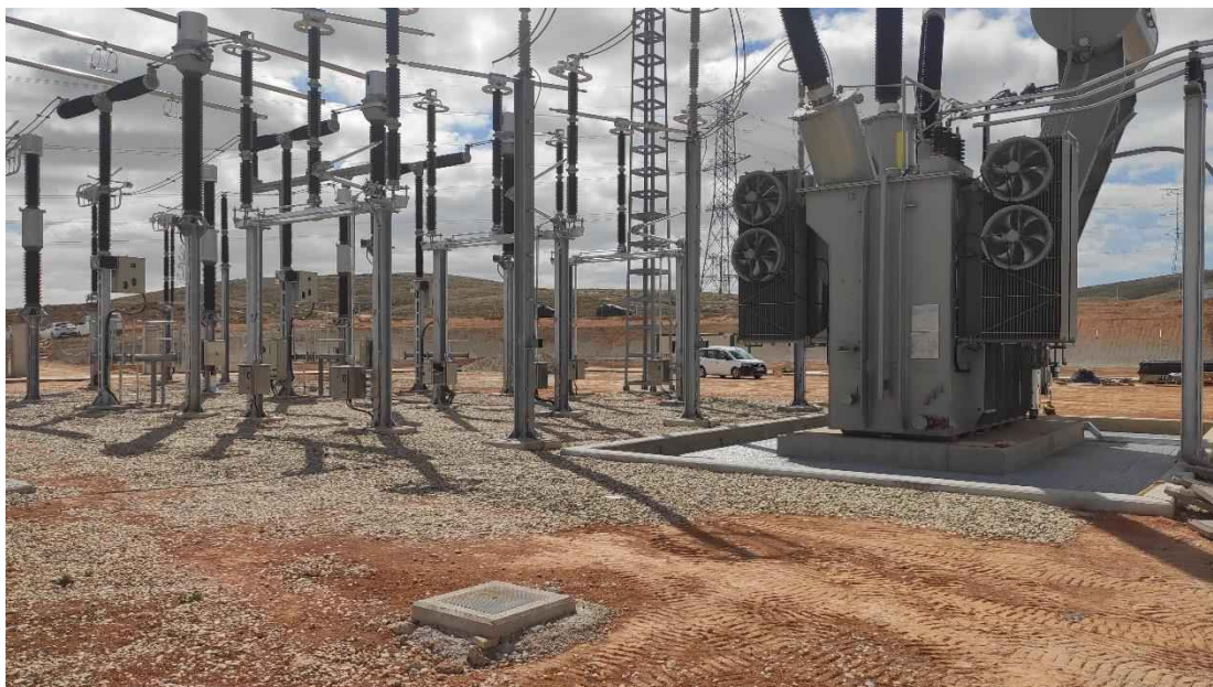
Foto 49. Vista general de la subestación. Mes de abril 2023.
