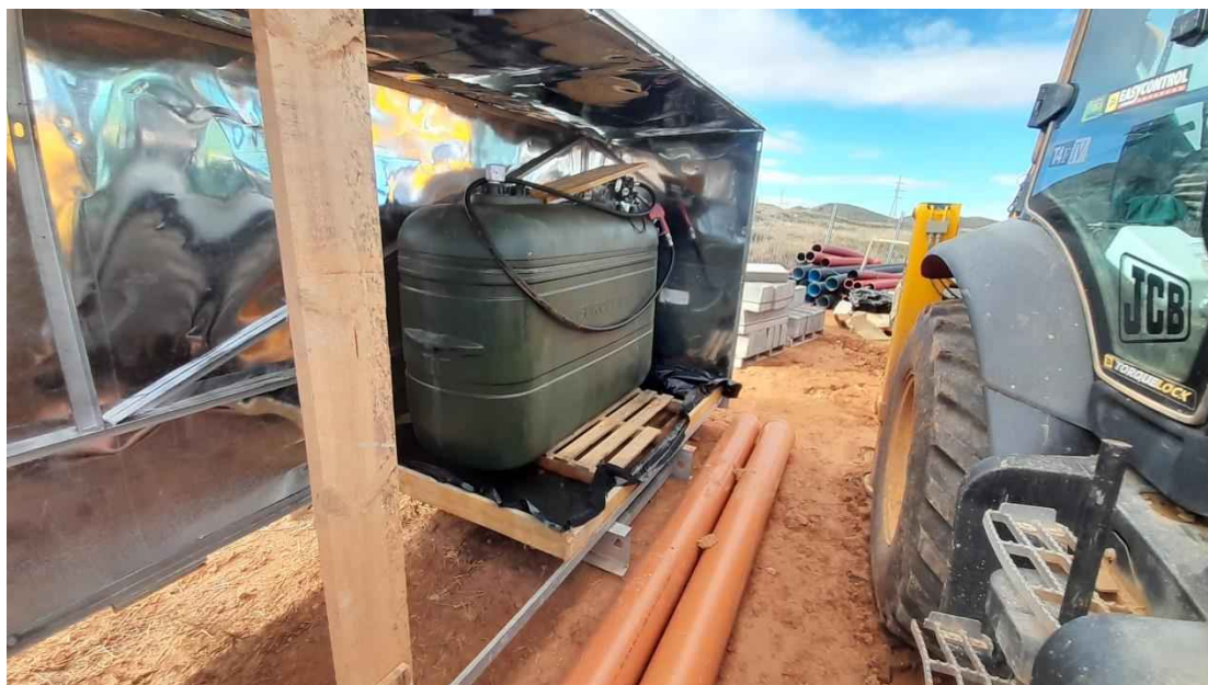
Foto 41. Depósito de gasoil en zona de instalaciones auxiliares.
