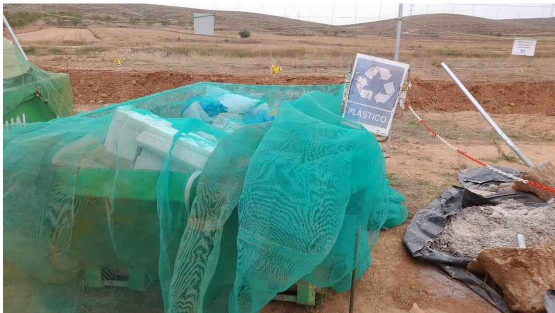
Foto 7. Zona de residuos de construcción y demolición (RCD). Contenedor de plásticos y envases
