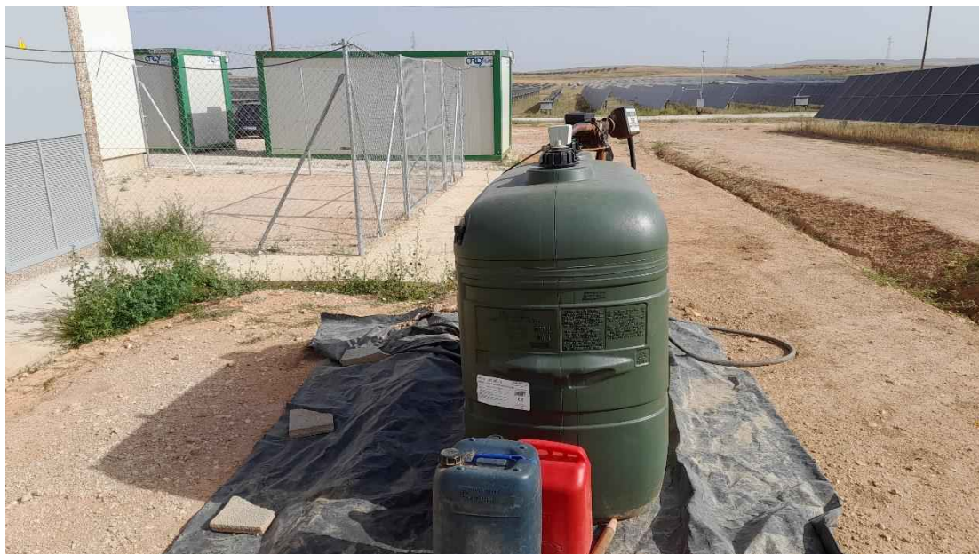
Foto 13. Depósito de gasoil en la zona de oficina de O&M
