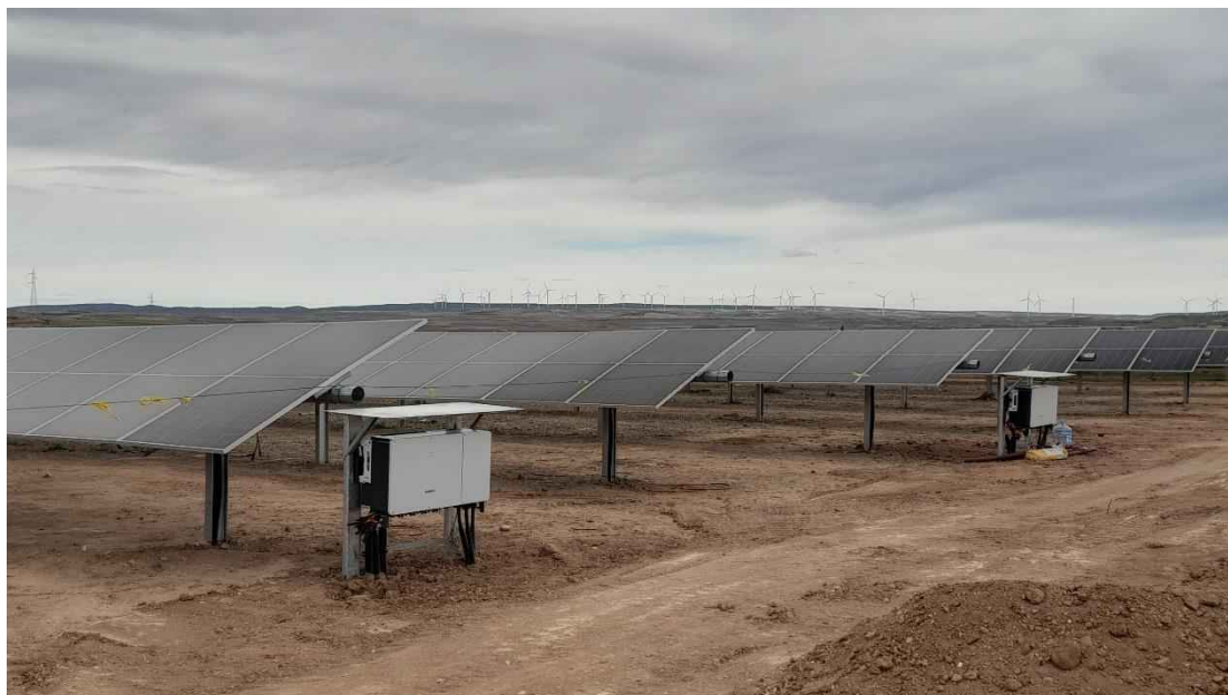
Foto 19. Vista general de zona con seguidores con paneles montados. Apreciación de señalización entre filas para evitar contacto eléctrico. Mes de febrero 2022.
