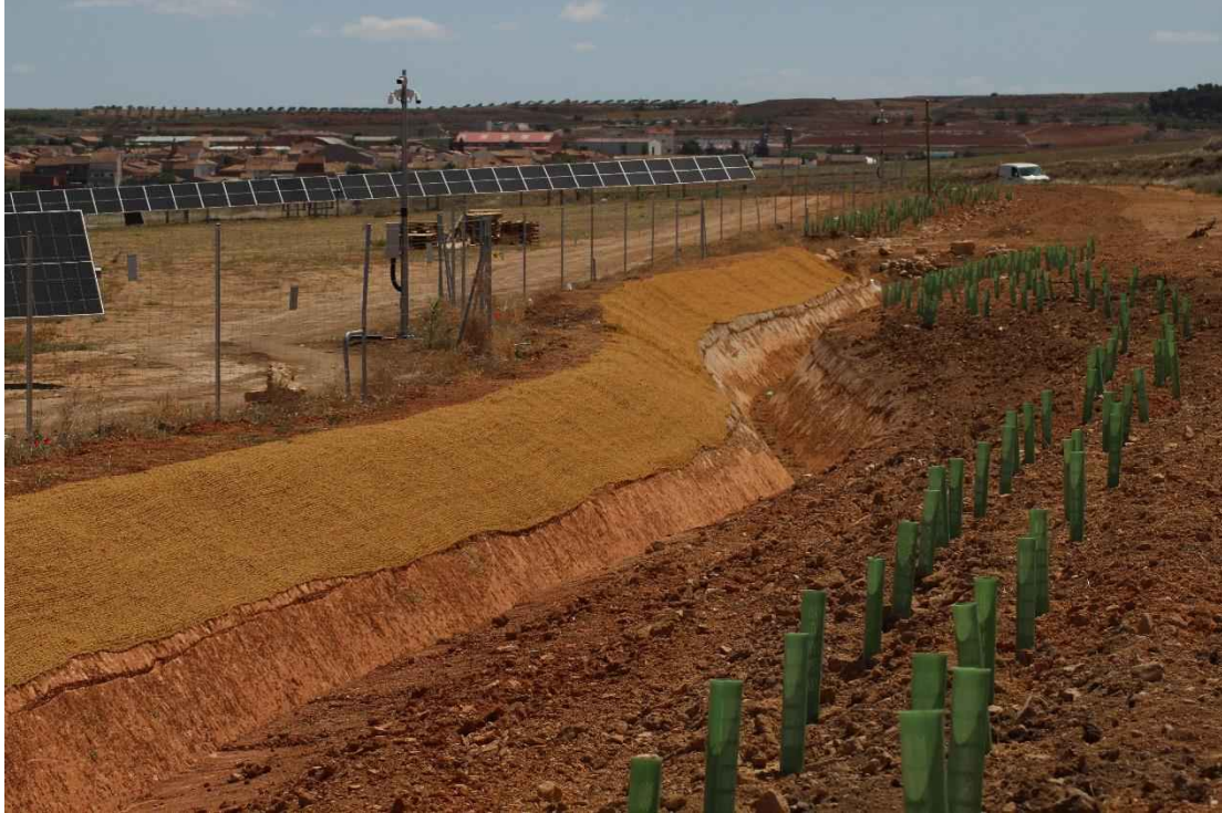
Foto 25. Aspecto de las labores de revegetación: manta orgánica en jarillón de protección de drenaje y banda de plantaciones.
