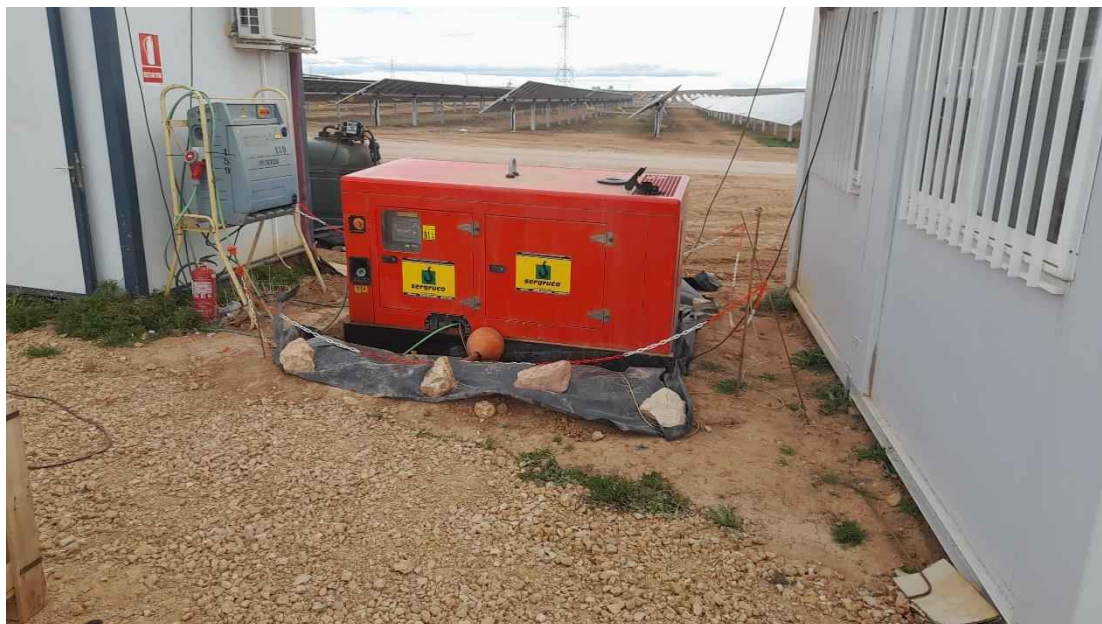
Foto 15. Grupo electrógeno en la zona de oficinas e instalaciones auxiliares.
