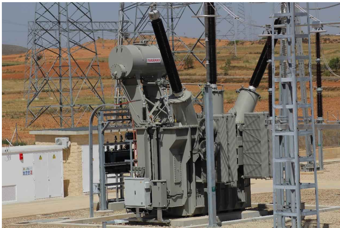
Foto 52. Vista del Trafo de la subestación. Mes de agosto 2023.
