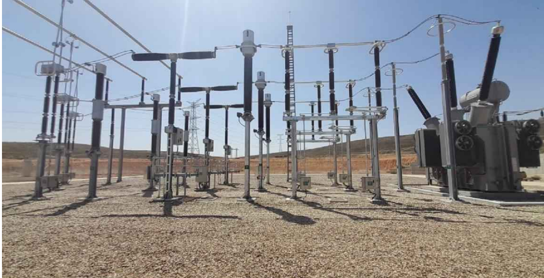
Foto 50. Vista general de la subestación. Mes de agosto 2023.
