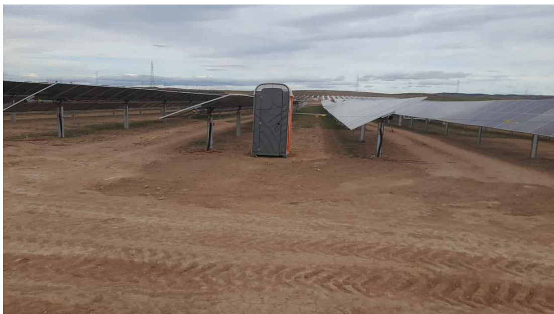
Foto 20. WC químico en zona de obra. Mes de febrero 2022.
