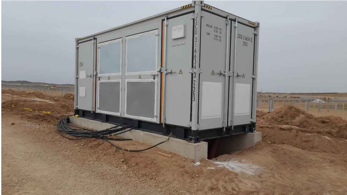
Foto 17. Centro de transformación
