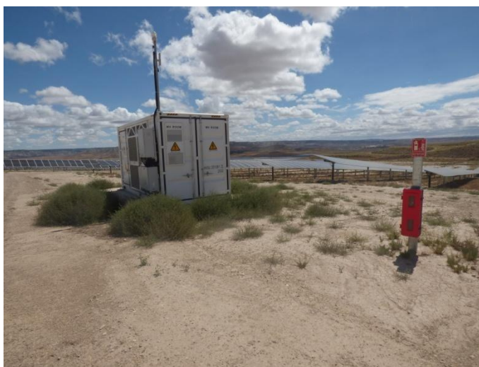
Imagen 42. Foto del extintor disponible junto a un centro de transformación.
