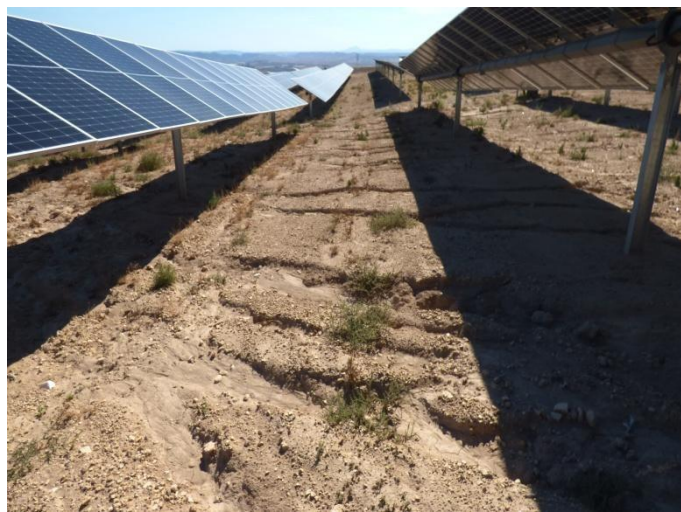
Imagen 3. Regueros locales de pequeña entidad bajo los paneles solares.
