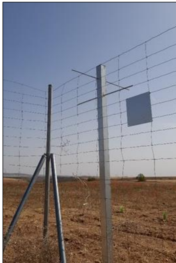
Figura 6: Ejemplo de poste posadero instalado en uno de los vértices del perímetro de la instalación.
