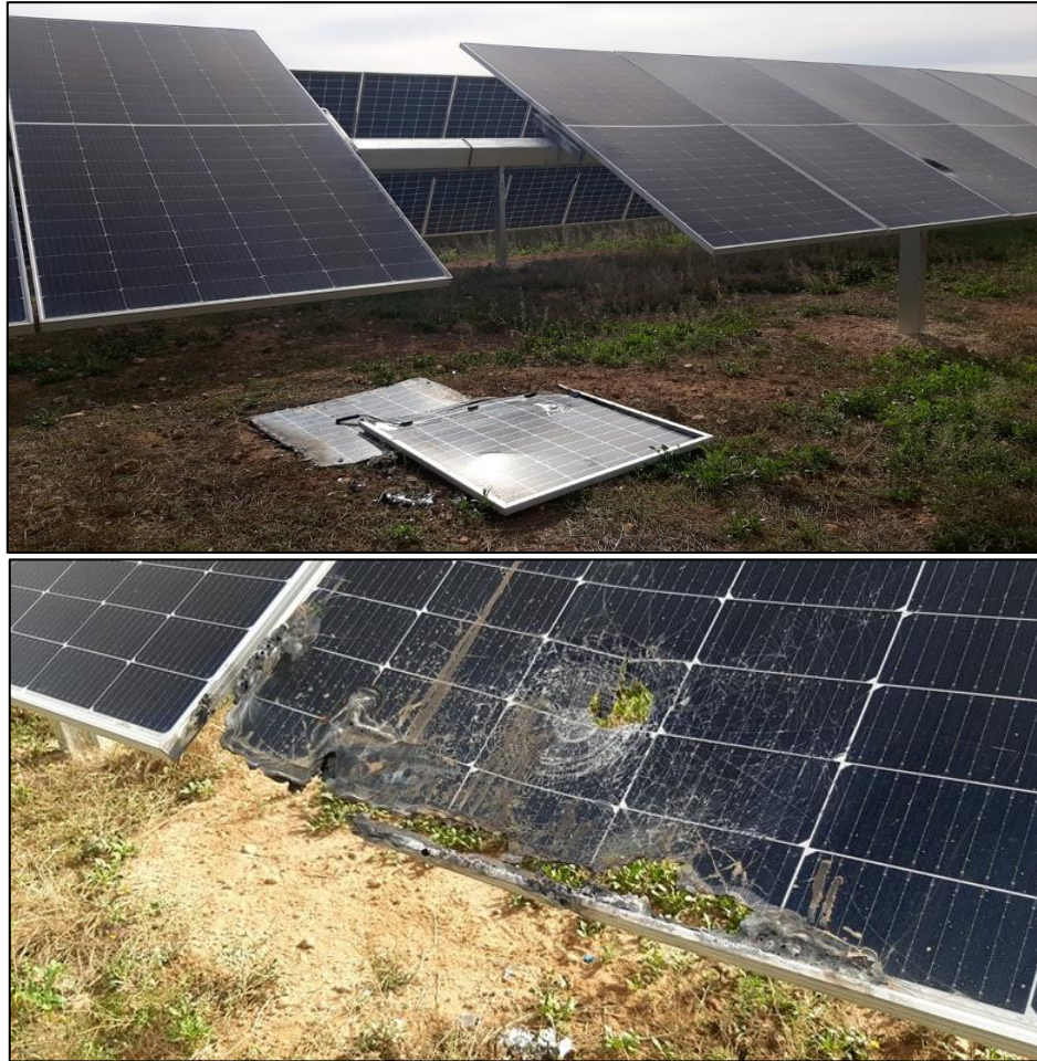
Figura 36: Paneles con daños y quemaduras registradas en septiembre
