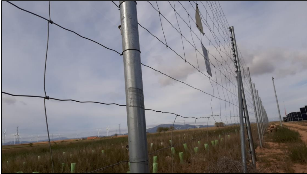
Figura 30: Tramo del vallado con alambres cortadas con alicate
