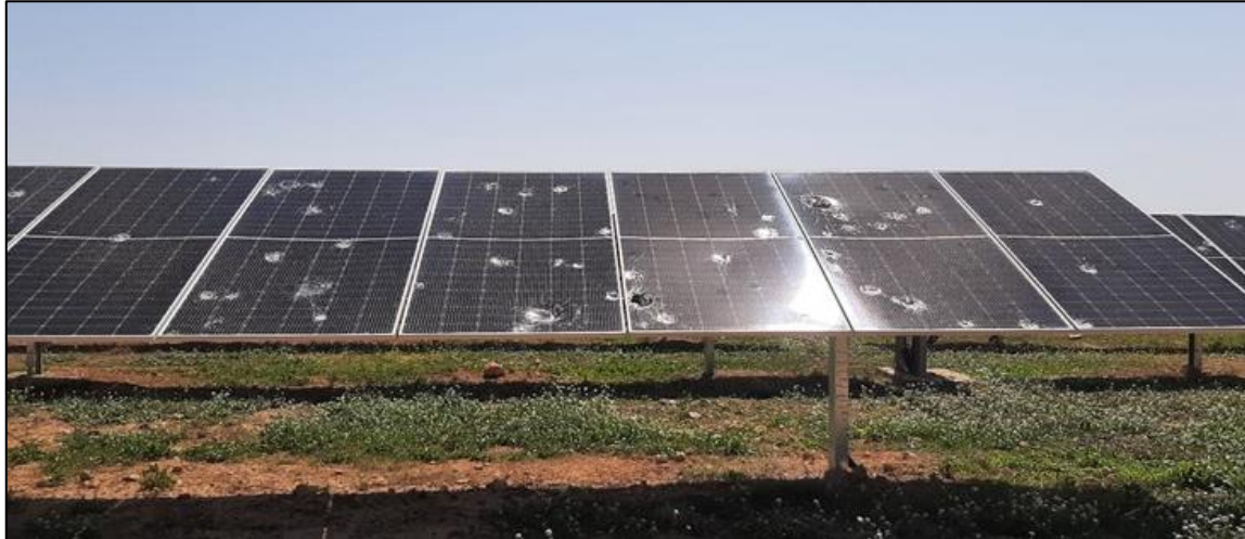
Figura 35: Daños provocados por el granizo en los paneles solares
