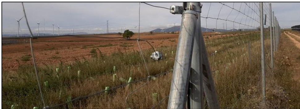
Figura 31: Empalme del vallado con un tensor roto.
