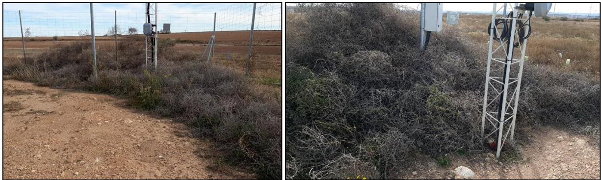
Figura 34: Vegetación rodada acumulada en una esquina dentro del perímetro vallado de la PSFV cubriendo parcialmente estructuras eléctricas
