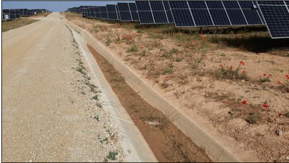
Figura 28: Canal de drenaje con pequeña acumulación de sedimentos y agua en junio de 2023 tras un episodio de lluvias.
