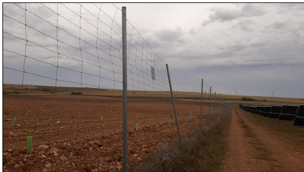
Figura 24: Poste ligeramente inclinado en la cara norte el vallado de la PSFV
