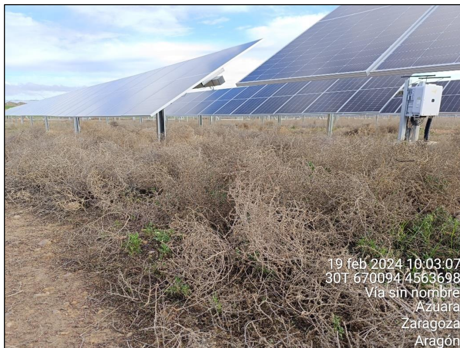
Figura 26: Vegetación rodada acumulada entre las filas de módulos solares.
