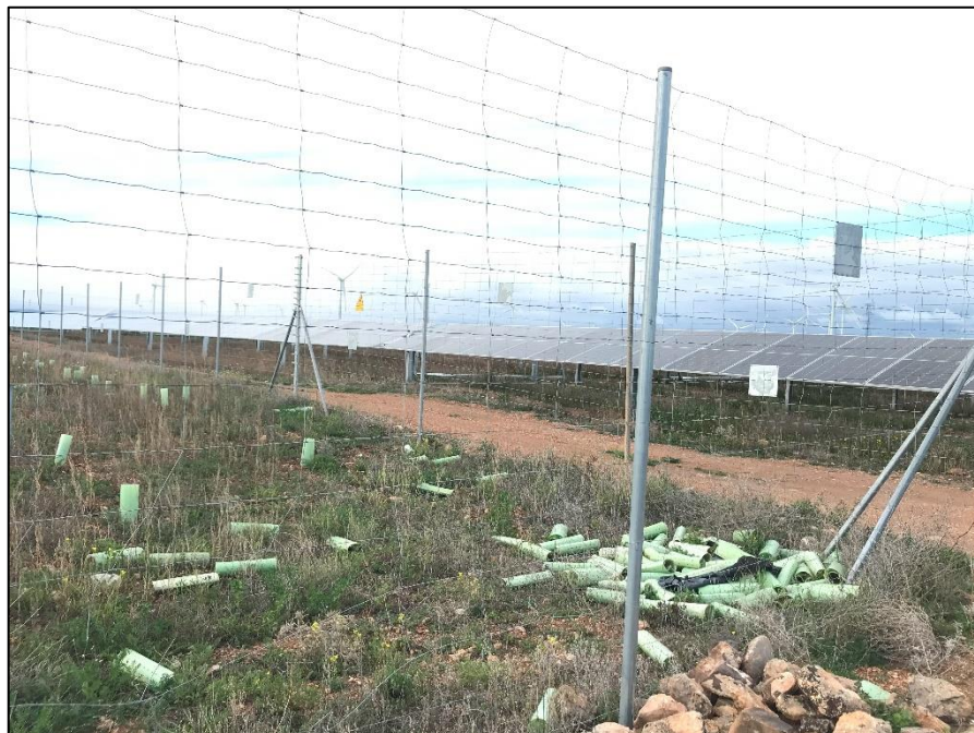
Figura 20: Cilindros protectores salidos de una de las bolsas rotas y acumulados en el perímetro de la PSFV.
