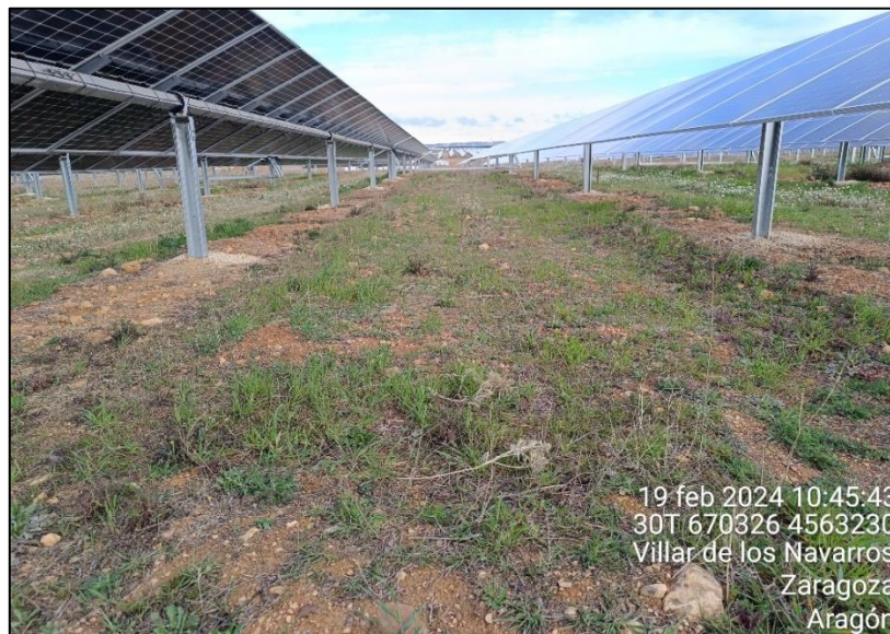
Figura 14: Revegetación por colonización natural desarrollada entre las filas de paneles.
